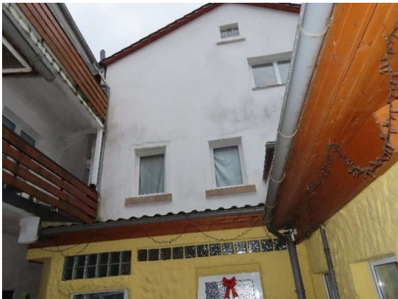
Verwitterte Fassade (Hinterhaus)
