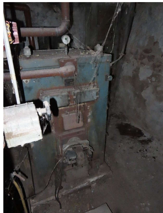
Defekte Ölheizung (außer Betrieb)
