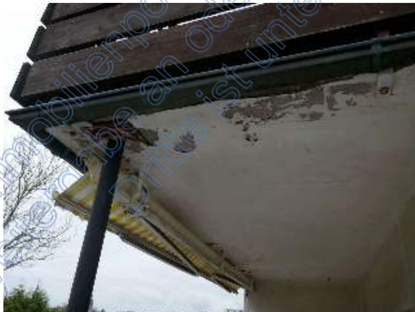
Bild 20: schadhafte Balkonplatte am "Altbau"
