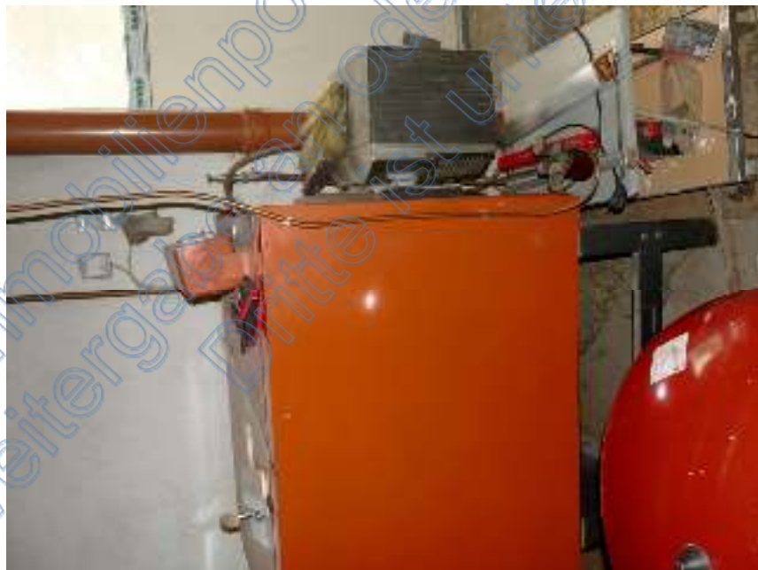
Bild 16: deaktivierte Heizungsanlage im "Altbau"
