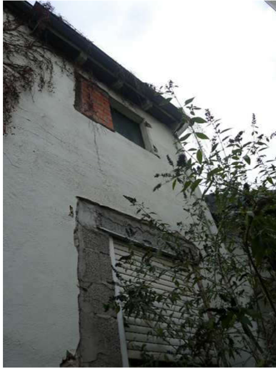
Bild 7: rückwärtiger Anbau (Bereich ehemalige Scheune - keine Baugenehmigung ersichtlich)
