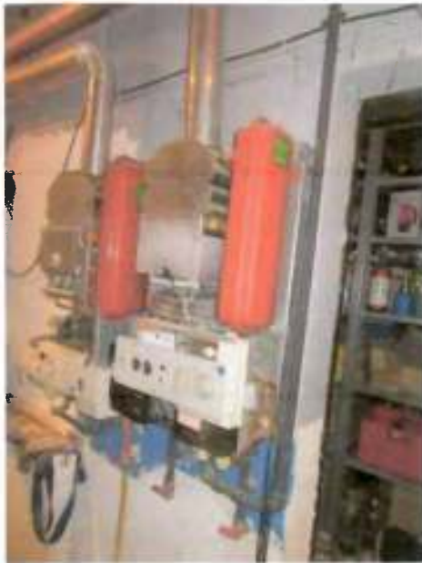
Haustechnik im Kellergeschoss
