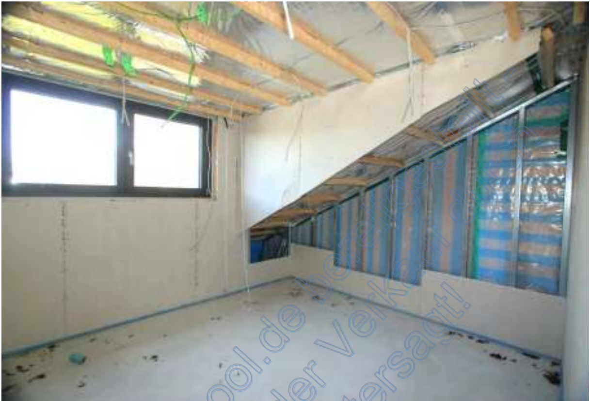
Kinderzimmer 1 mit Dachgaube im Osten, Tierkot auf dem Boden
