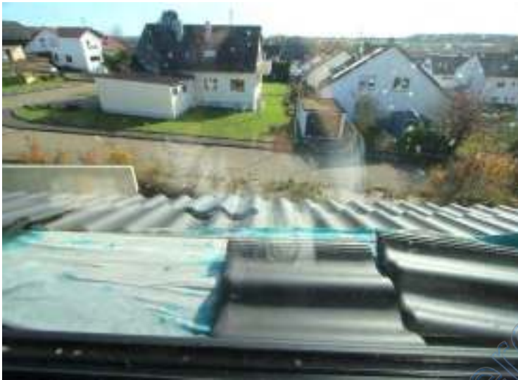
Blick aus dem Fenster nach Süden, lose Dachziegel
