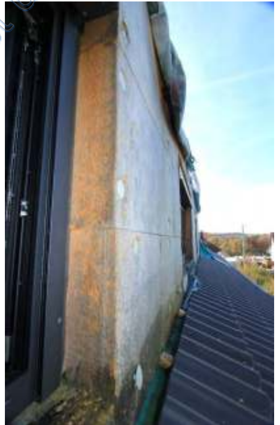
Durchnässte Außendämmung Gaupe
