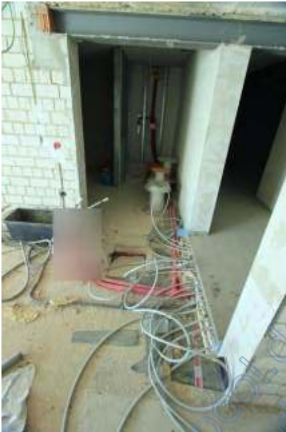
Anschlüsse Fußbodenheizung im Flur
