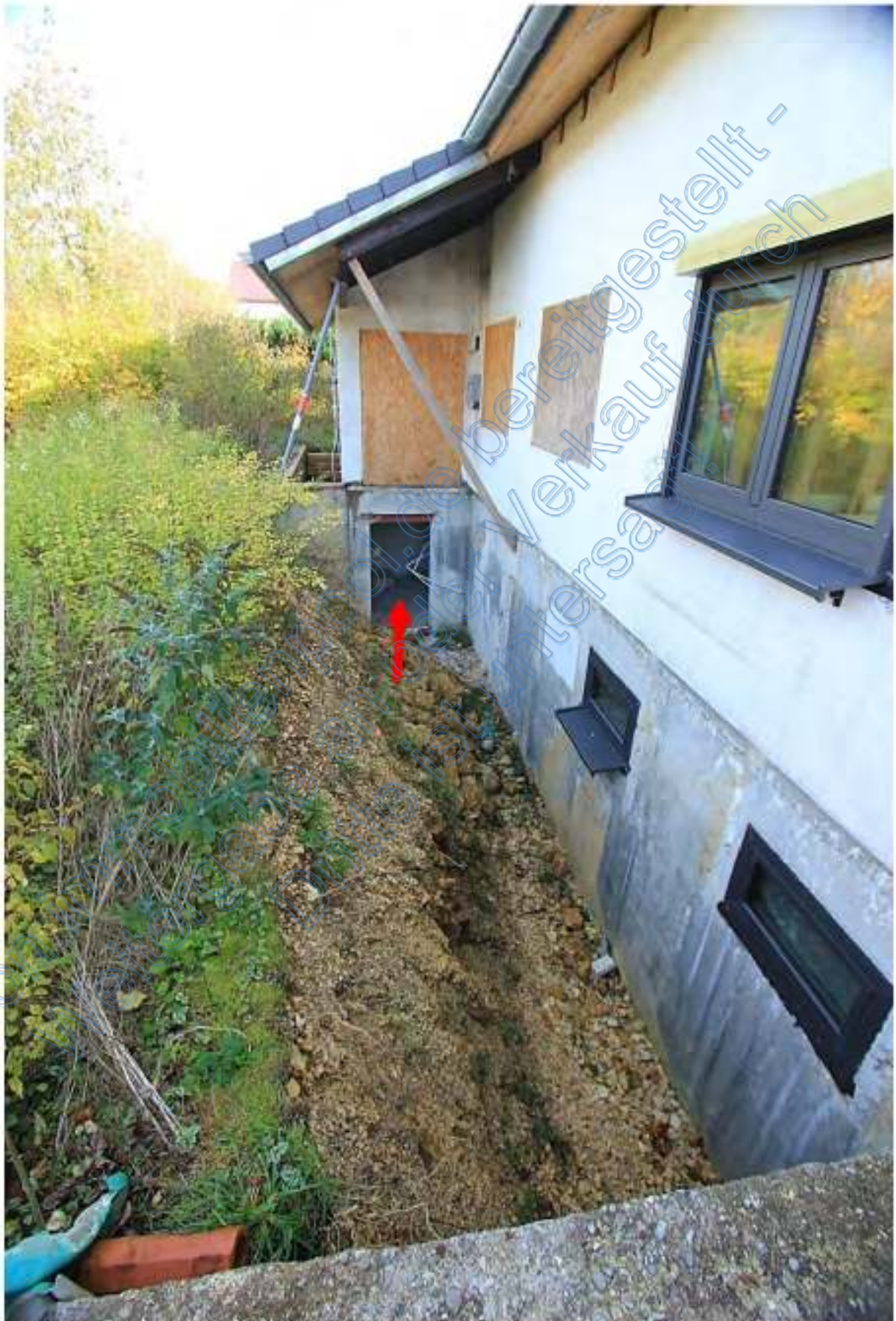
Nordseite Wohnhaus mit Graben vor dem UG, Pfeil offener Zugang zum UG des Wohnhauses
