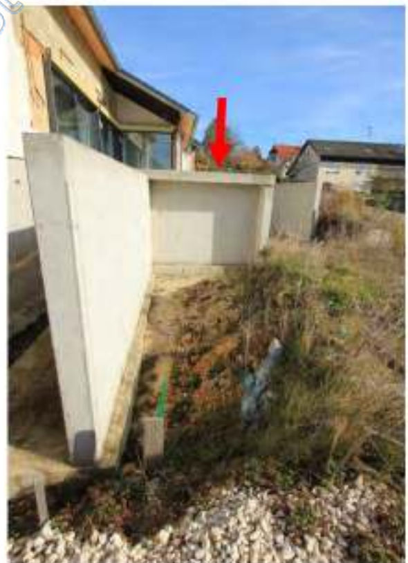
Sichtschutzwand, Pfeil Terrasse
