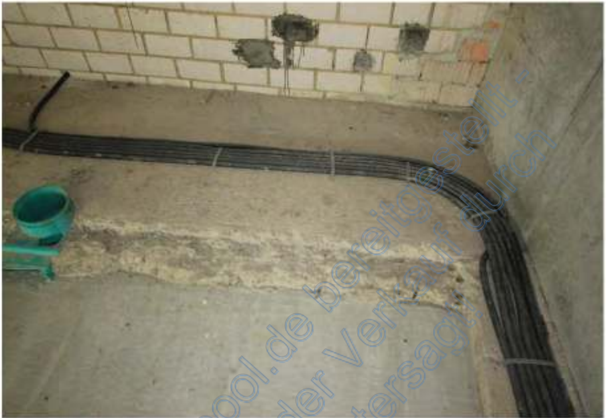
Leerrohre am Boden
