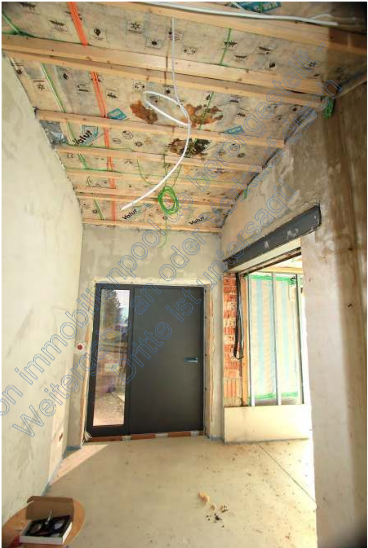
Windfang mit Haustür, rechts Durchgang zum Wohnzimmer, Feuchtflecken an der Decke
