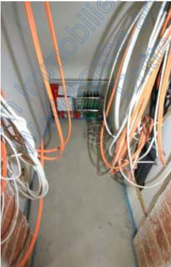
Technikraum unter der Kellertreppe
