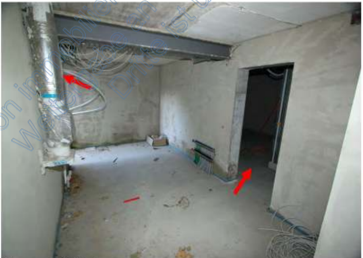
Heizungsraum, Pfeil Bunker
