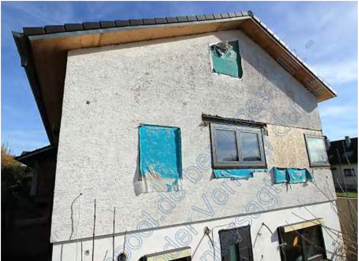
Westgiebelseite Wohnhaus mit Putzschäden
