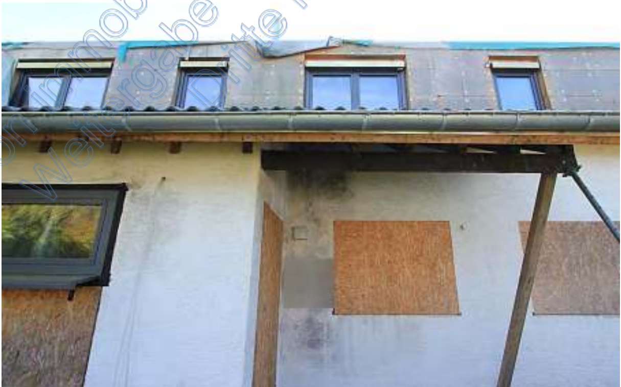
Nordfassade mit Schimmelflecken und der Witterung ausgesetzten Dämmung der Dachgaube
