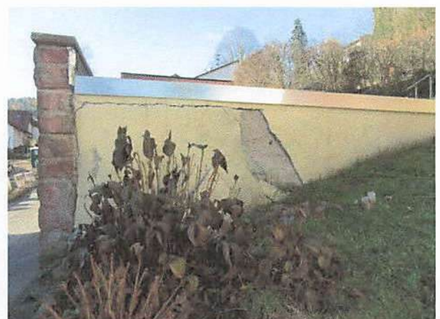
Schäden Ostfassade Garage
