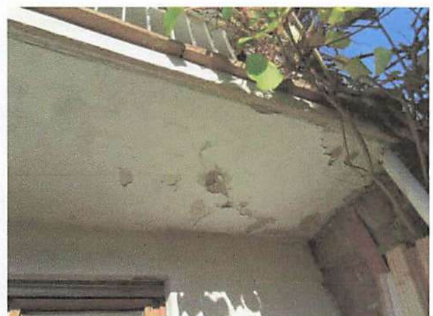
Schäden Unterseite Balkonplatte
