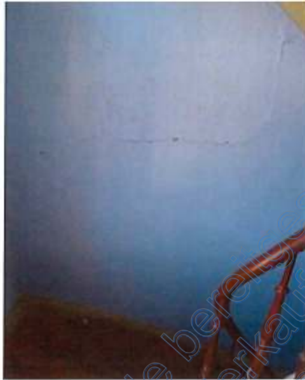
Foto 12: Riss im Treppenhaus
