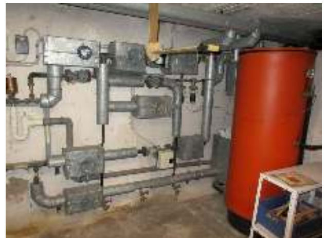
Heizungstechnik und Warmwasserbehälter im KG
