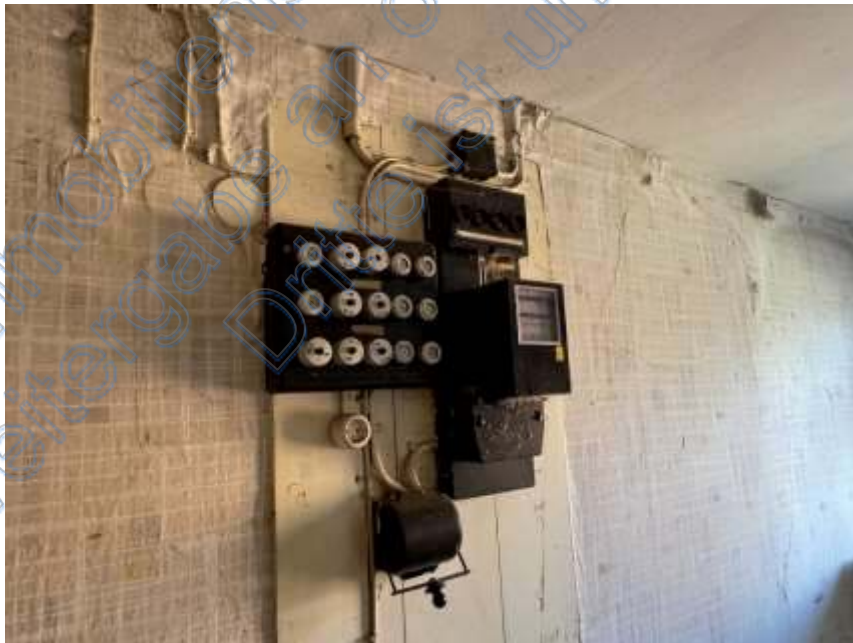
Bild 10: Elektrik im Obergeschoss
