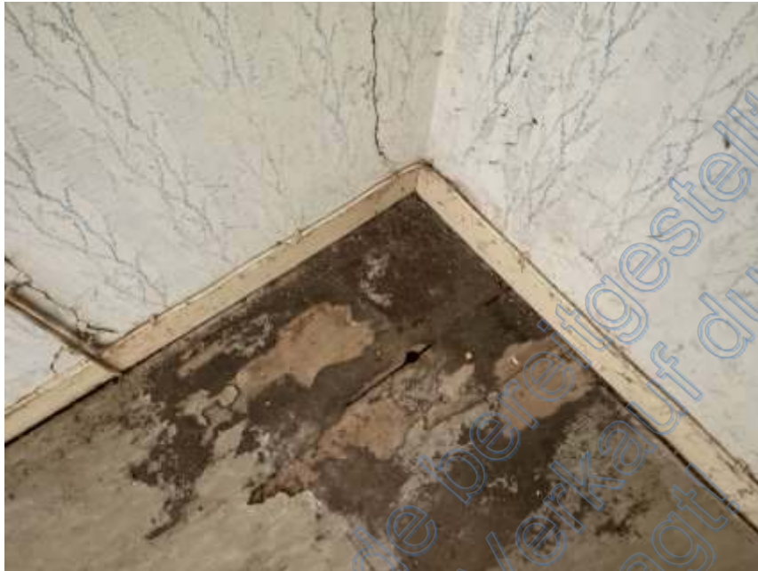
Bild 9: Beschädigter Bodenbelag im Obergeschoss
