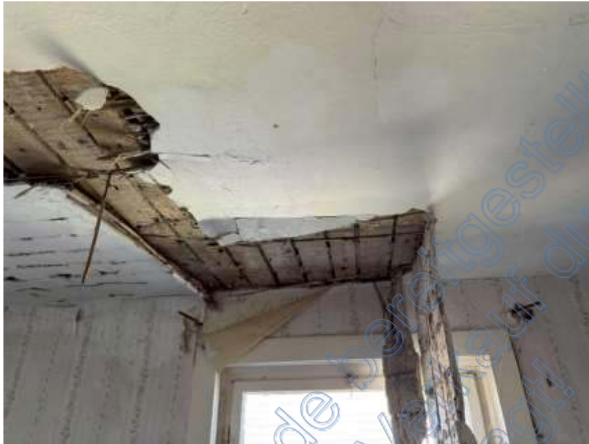
Bild 11: Beschädigte Decke im Obergeschoss
