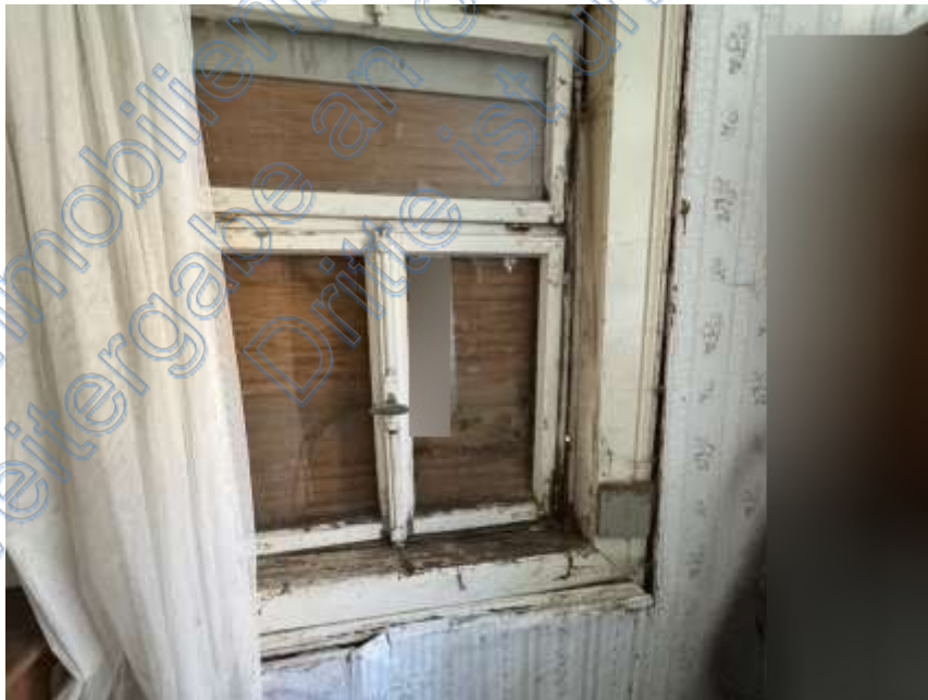
Bild 6: Beschädigtes Fenster im Erdgeschoss
