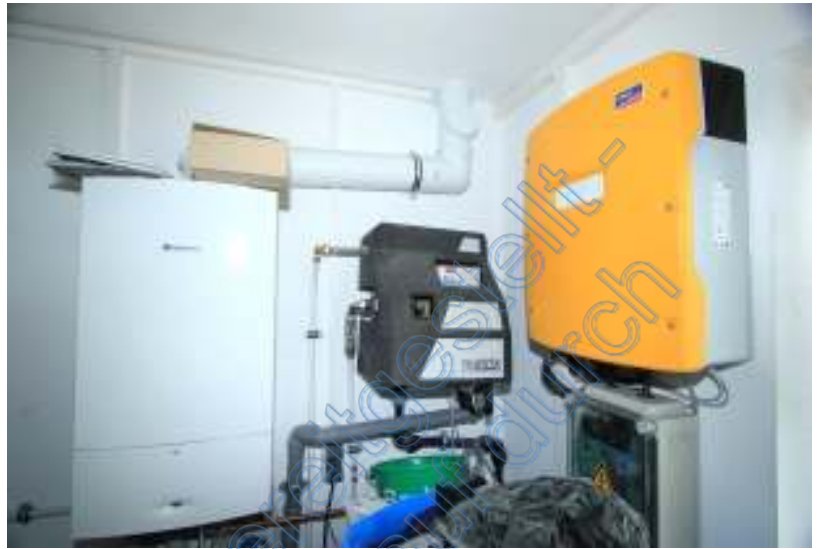
Technikraum mit Gasterme und Wechselrichter
