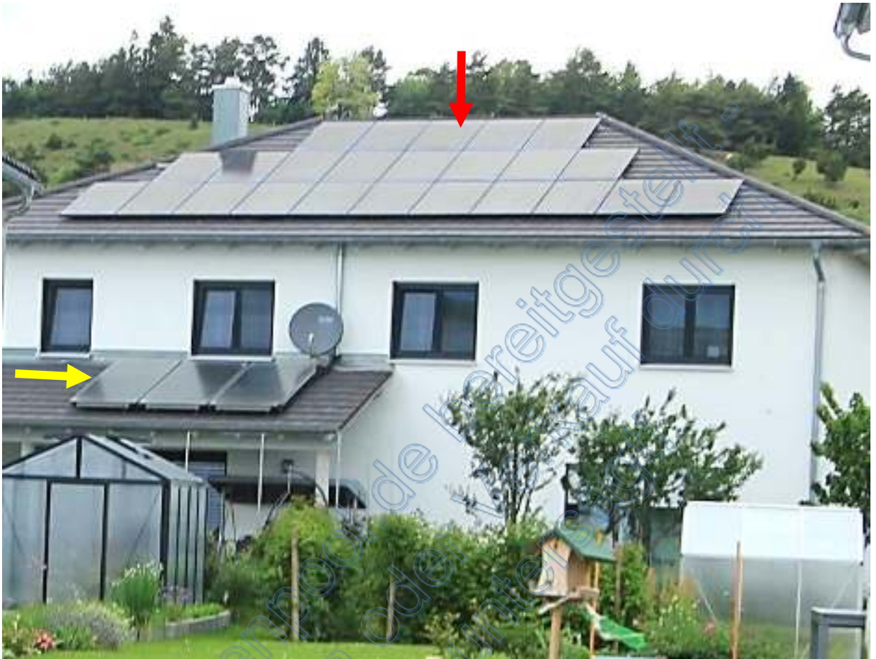
Südseite Wohnhaus, gelber Pfeil Solaranlage für Heizung, rot Photovoltaikanlage für Strom
