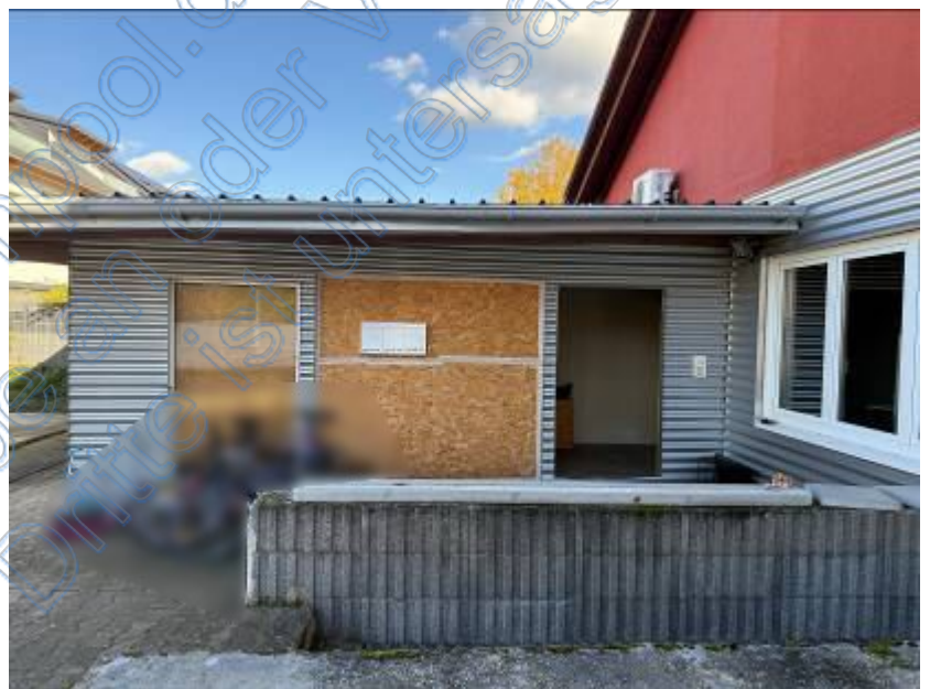
Abb. 5: Foto des SV; z.T. Fassade nicht fertiggestellt (Eingangsvorbau)
