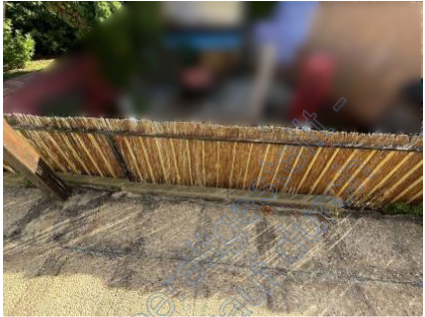
Abb. 6: Foto des SV; Absturzsicherung Terrasse zum tieferliegenden Nachbargrundstück unzureichend/zu niedrig
