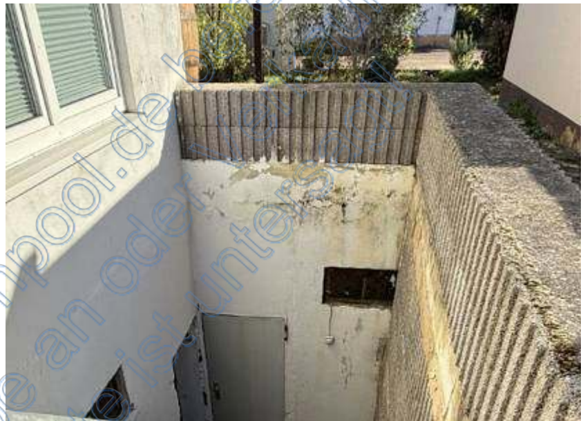
Abb. 3: Foto des SV; z.T. Fassade schadhaft (Putzschäden)
