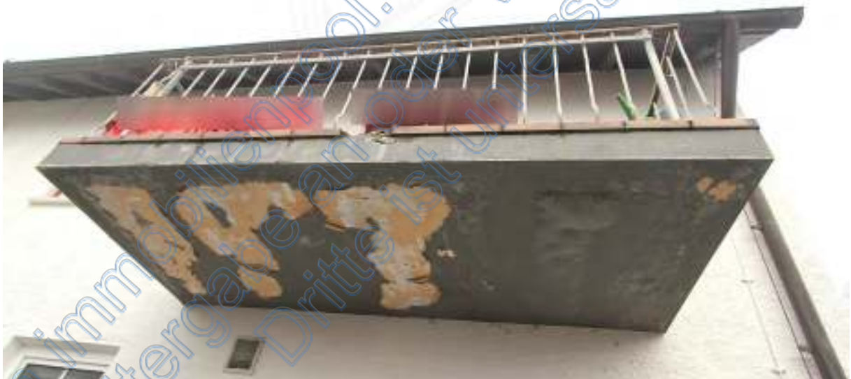
Unterseite Balkon mit Schäden
