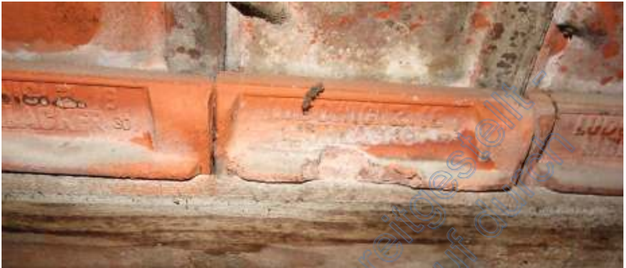
Alte Dachziegeldeckung mit Schäden
