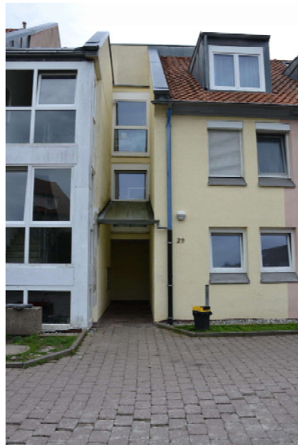
Bild 10: Nordansicht Maulacher Straße 29, Hofbefestigung erneuerungsbedürftig
