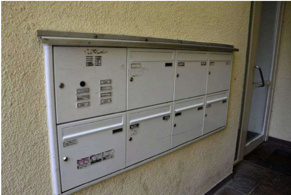
Bild 13: Briefkastenanlage, Maulacher Straße 29, Hauseingangsbereich
