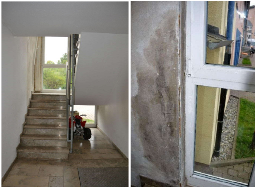
Bild 14a,b: Erdgeschoss Maulacher Straße 29, Treppenhausbereich, Schäden vorhanden (z.B. Treppenstufen vermutlich durch Salzausblühungen beschädigt, Fenstereinbau (Dichtungsschaum erkennbar), allgemeine Vernachlässigung)
