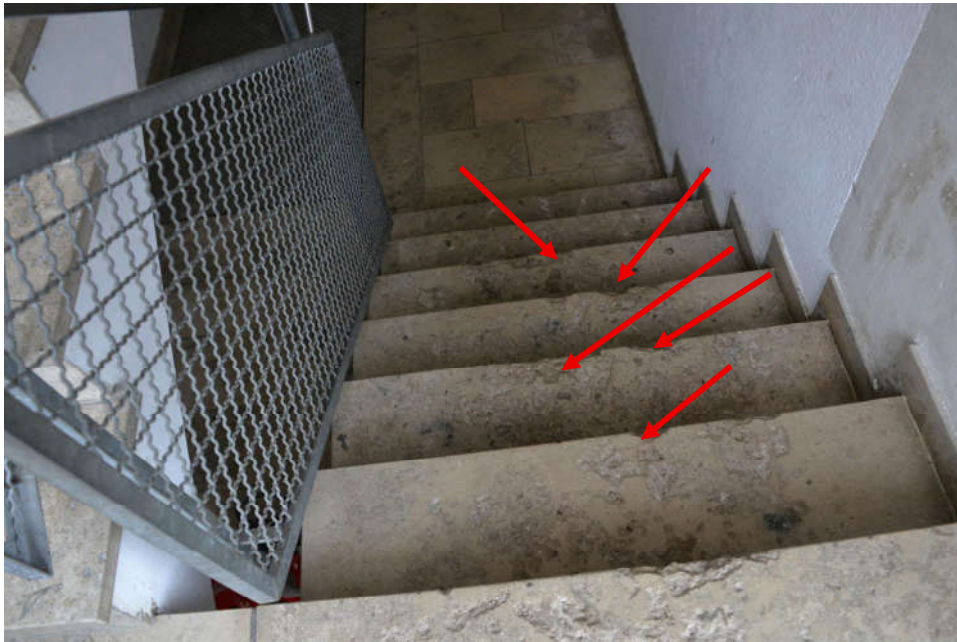
Bild 15: Natursteintreppe mit erheblichen Schäden, Sicherheit beeinträchtigt (Rutsch-/Stolpergefahr)
