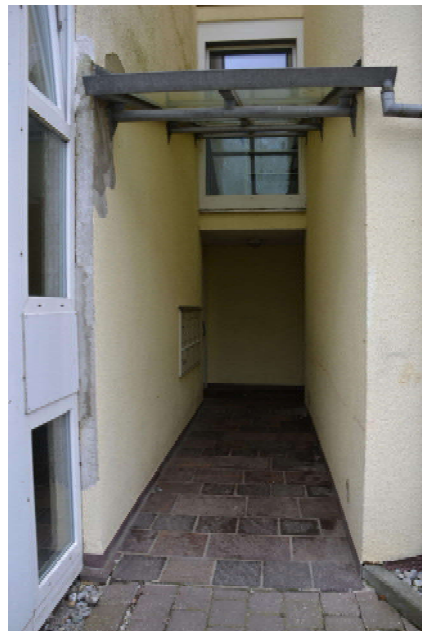
Bild 12: Schäden an der Fassade am Hauseingangsbereich
