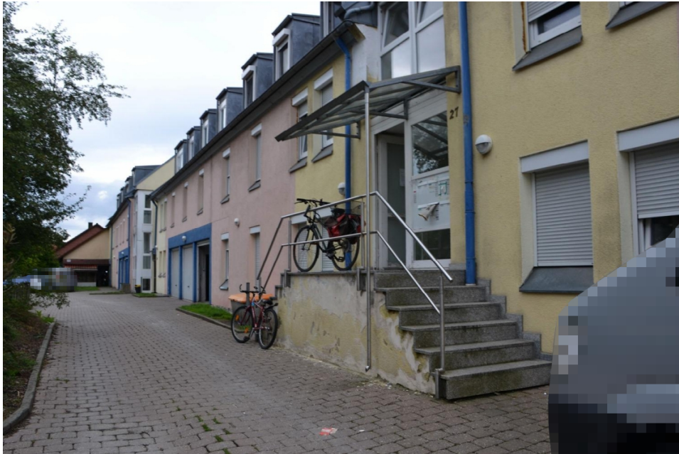
Bild 7: Nordwestansicht Maulacher Straße 27 und 29, Schäden Eingangstreppe/Fassade
