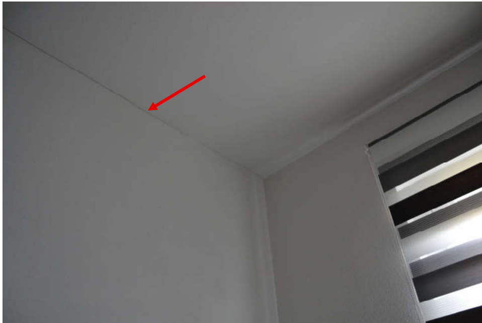
Bild 19: Dachgeschoss, Bad, Risse (Pfeil)
