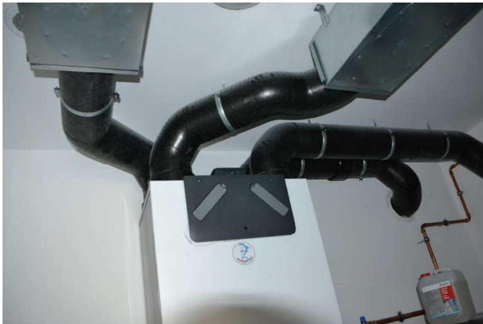
Bild 12: Erdgeschoss Be- und Entlüftungsanlage
