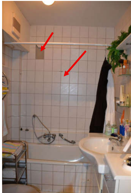
Bild 17: Untergeschoss sanitäre Anlage (innenliegendes Duschbad), Fliesenbelag beschädigt und lose, vgl. Pfeile
