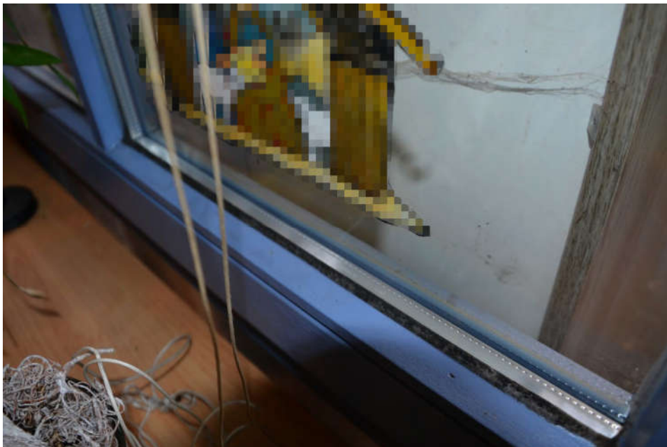
Bild 16: Untergeschoss Abdichtungsmaterial der Holzsparsenfenster (Baujahr ca. 1981) mit Schimmelpilzbefall
