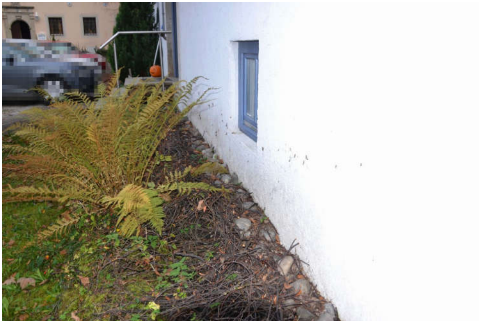
Bild 20: mangelhafte Abdichtung Fassade gegen Außenanlagen, z.B. fehlender Spritzschutz; Überprüfung der Bitumendickbeschichtung, Noppenbahn erforderlich
