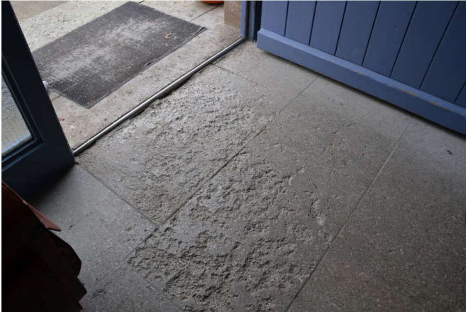
Bild 19: Erdgeschoss Schäden, Hauseingangsbereich (Salzschäden)
