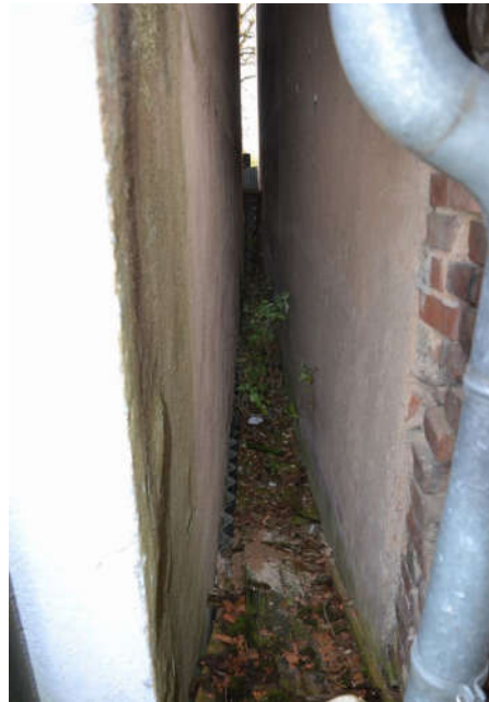
Bild 21: Westfassade, Fassade grenznah, vermutlich nicht fachhandwerkliche Verputzarbeiten, vermutlich DIN-Norm/Vorgaben der Arbeitsblätter, Stand der Technik wurde vermutlich nicht eingehalten.
