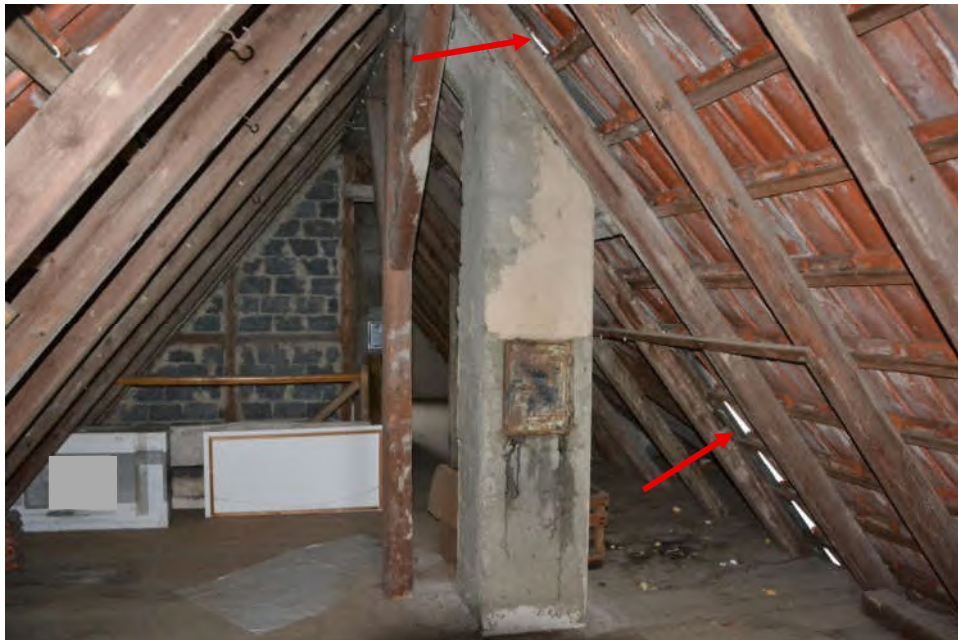
Bild 32: Dachhaut ungedämmt, erneuerungsbedürftig, freie Lüftung (Pfeile)
