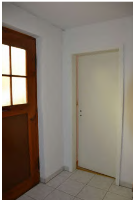
Bild 16: Erdgeschoss Windfang, Haustür mit freier Lüftung; Wohnbereich nicht in sich abgeschlossen (Schlafzimmertür)
