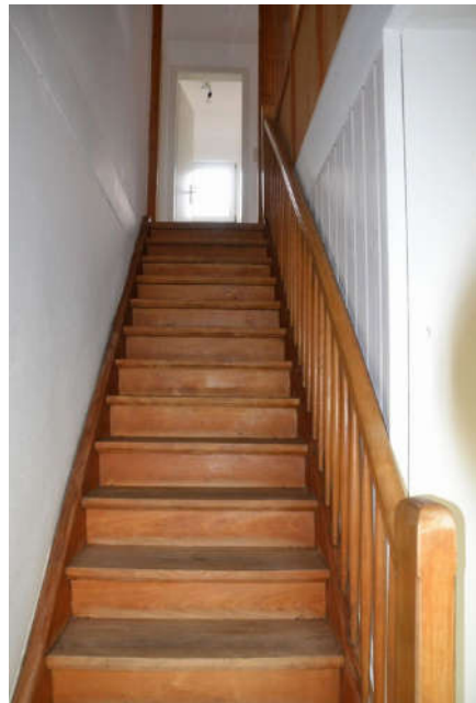
Bild 24: Erdgeschoss knarrende Geschosstreppe ins Dachgeschoss
