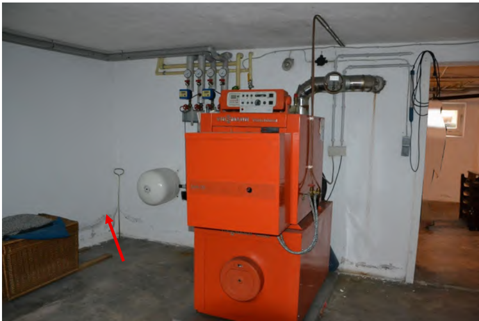
Bild 14: Untergeschoss Heizungskeller, Ausblühungen erkennbar
