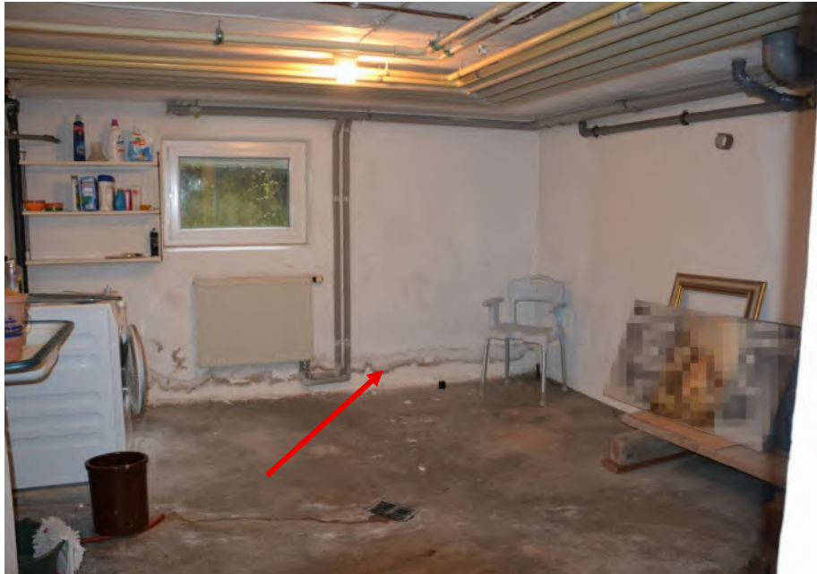
Bild 13: Untergeschoss Ausblühungen erkennbar (Pfeil)
