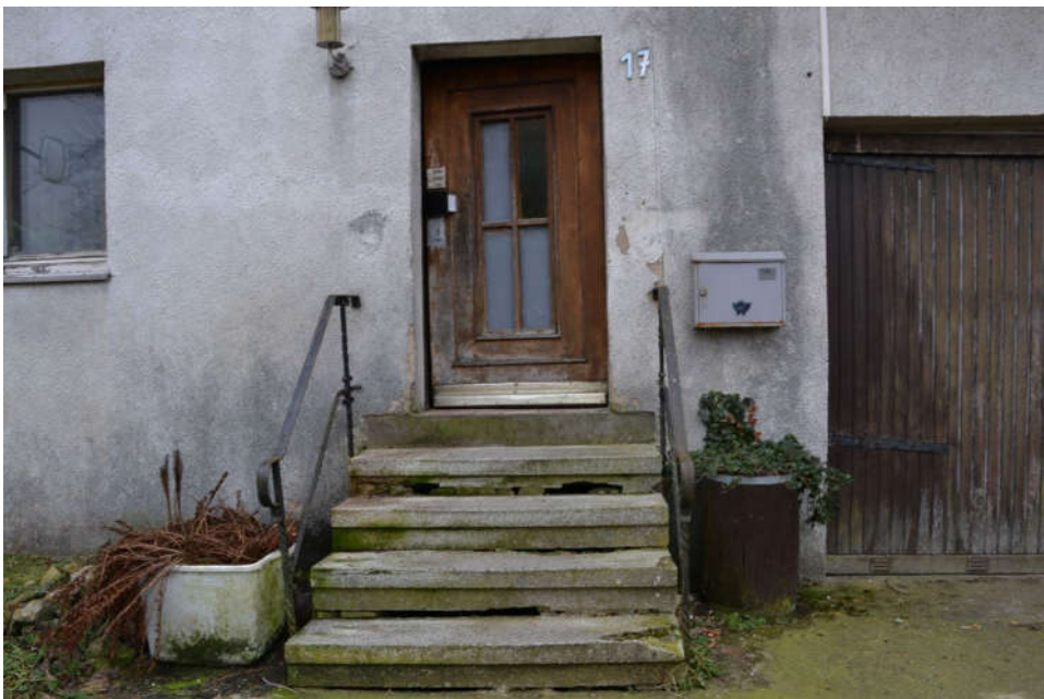
Bild 6: Nordansicht, stark vernachlässigter Hauseingangsbereich
