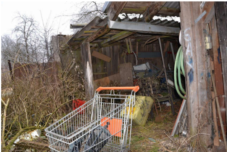
Bild 12: Nordansicht Außenanlage, Entsorgungsarbeiten erforderlich
