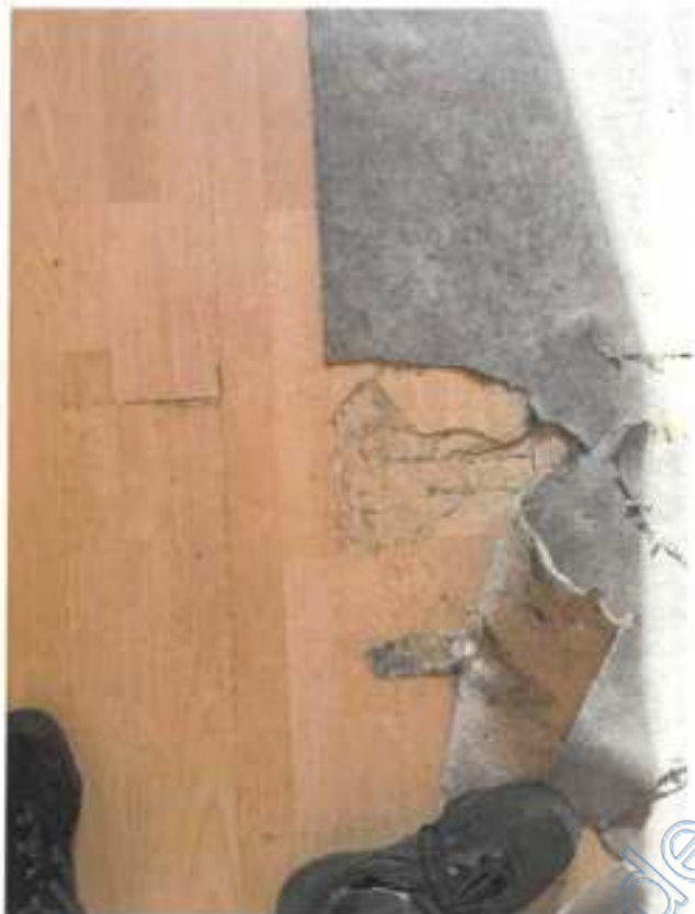
Schaden am Laminatboden
