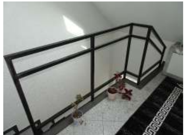
Treppengeländer mit fehlender Absturzsicherung OG
