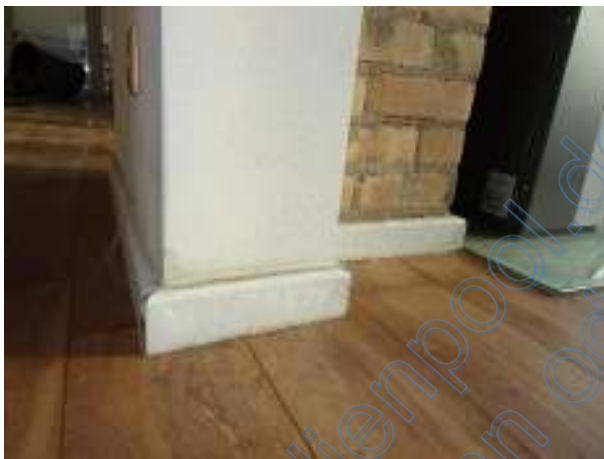
Wasserschäden OG (nWS)
