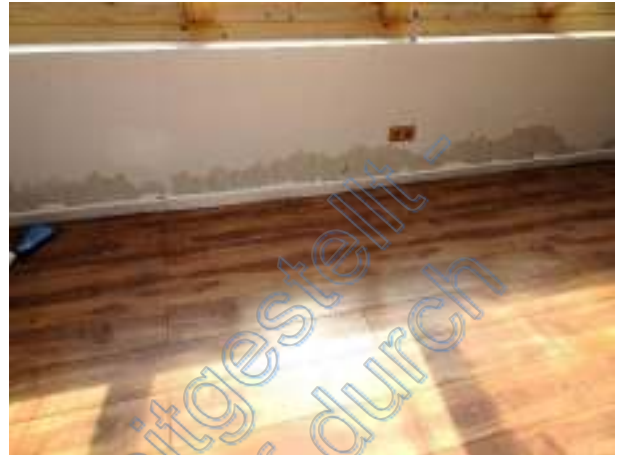
Wasserschäden OG (nWS)
