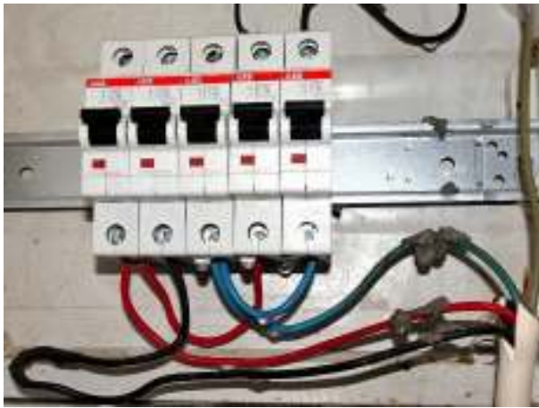
Unterverteiler OG (nWS)
