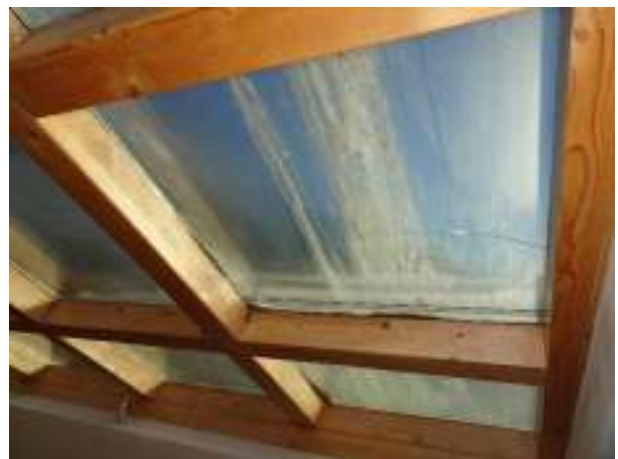
Fenster im Loft mit Schäden (vWS)
