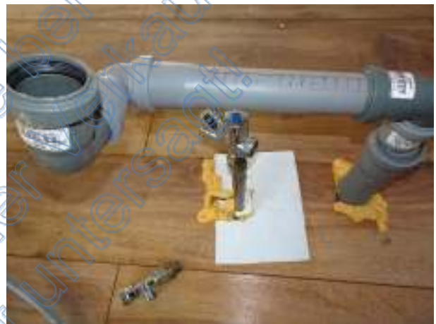
Wasserschäden OG (nWS)
