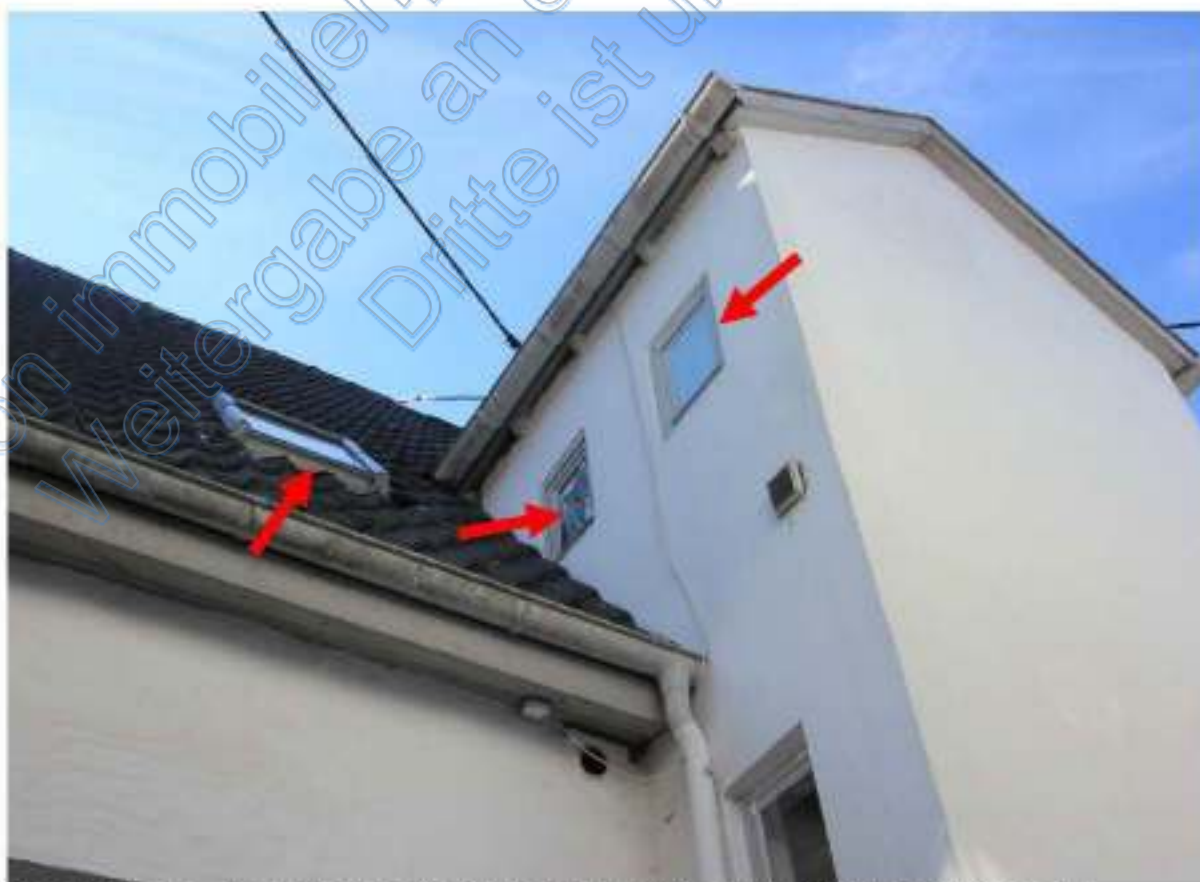
Dach im Norden, Pfeile Dachfenster Küche, Fenster Speis und WC Nr. 2 im Quergiebel
