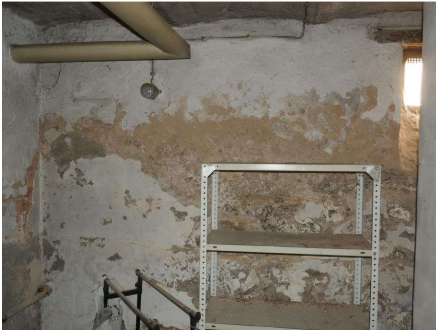
Bild 11: Kellerwände (baujahrestypische Feuchtigkeitsschäden)
