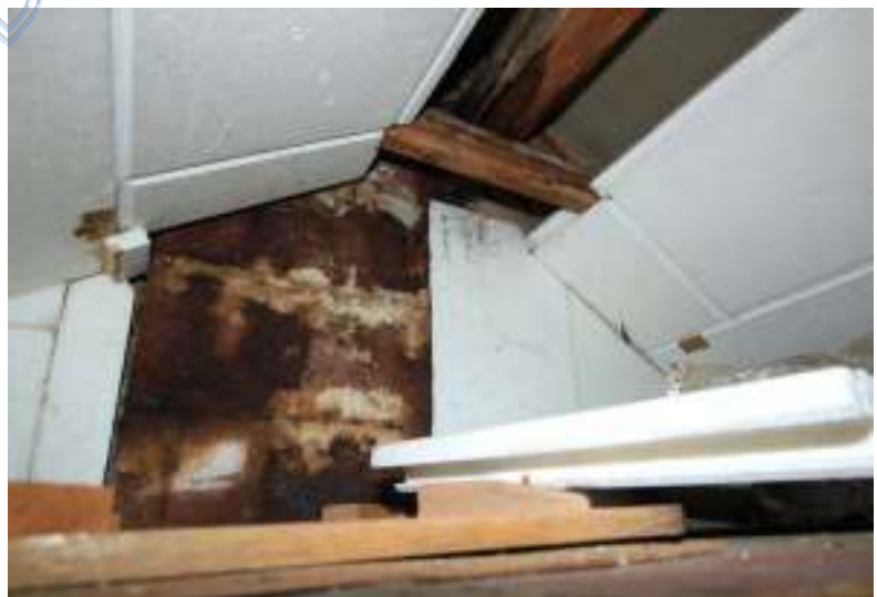
Dachspitz mit Stockflecken
