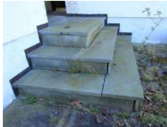
Eingangstrepfenbelag mit Ablösungen
