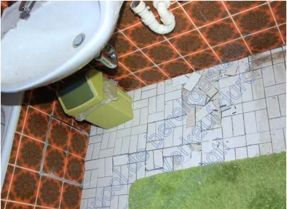
Abgelöste Fliesen im Bad
