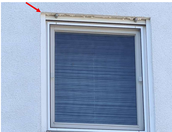
Farbabplatzungen am Rollladenschien
