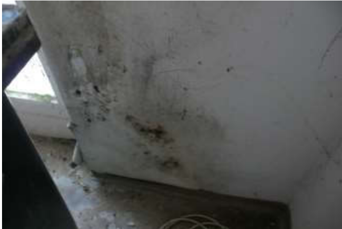
Schimmel im Bereich der Balkontür, Übergang zum Dachgeschoss
