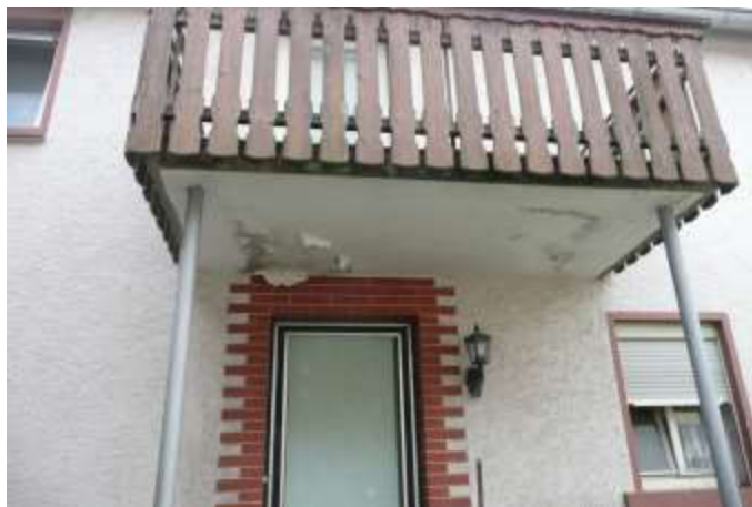
Feuchtigkeitsschäden Balkon über dem Hauseingang
