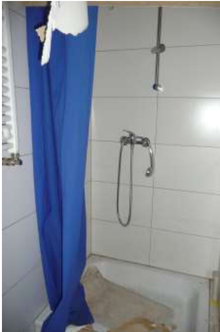
Bad Erdgeschoss, teilrenoviert
