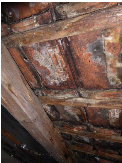
29. Feuchtigkeit Dach Speicherraum
