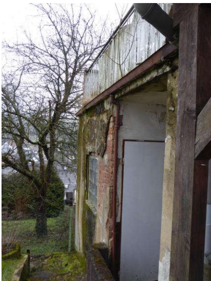
9. Starke Feuchteschäden – undichter Balkon
