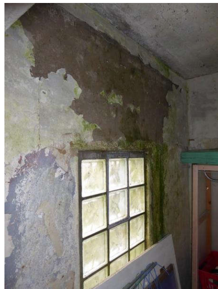
10. Starke Feuchteschäden Außenabstellraum
