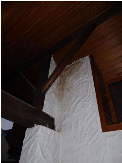
27. Feuchtigkeit am Kamin
