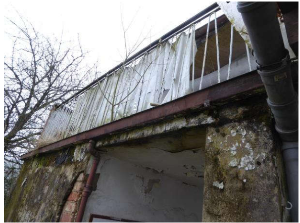
8. Starke Feuchteschäden – undichter Balkon
