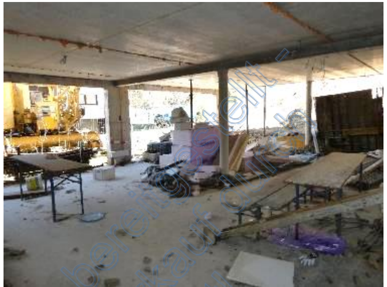
Teilansichten Garagenraum (mit eingedrunenem Geröll)
