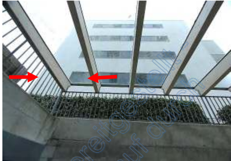
Glasdach der TG, rote Pfeile Schlafzimmer SE 2/4 im 1. OG
