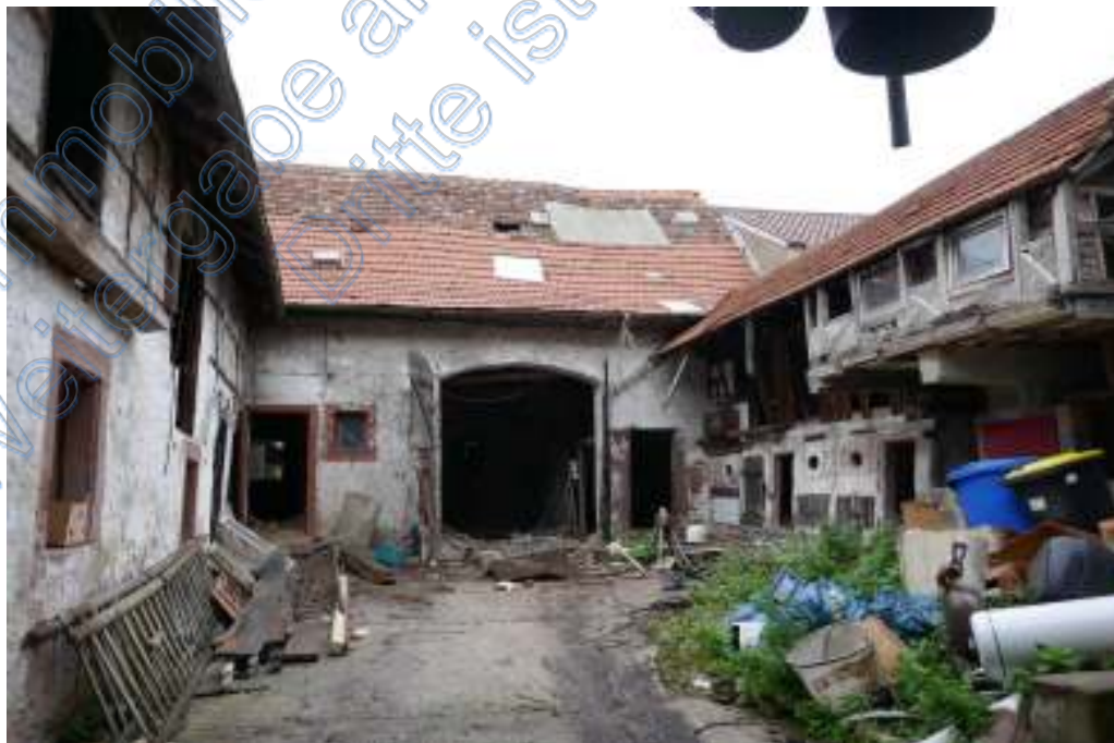
Blick auf das Scheunengebäude mit angrenzenden Schuppengebäuden. Das Dach der Scheune ist undicht.
