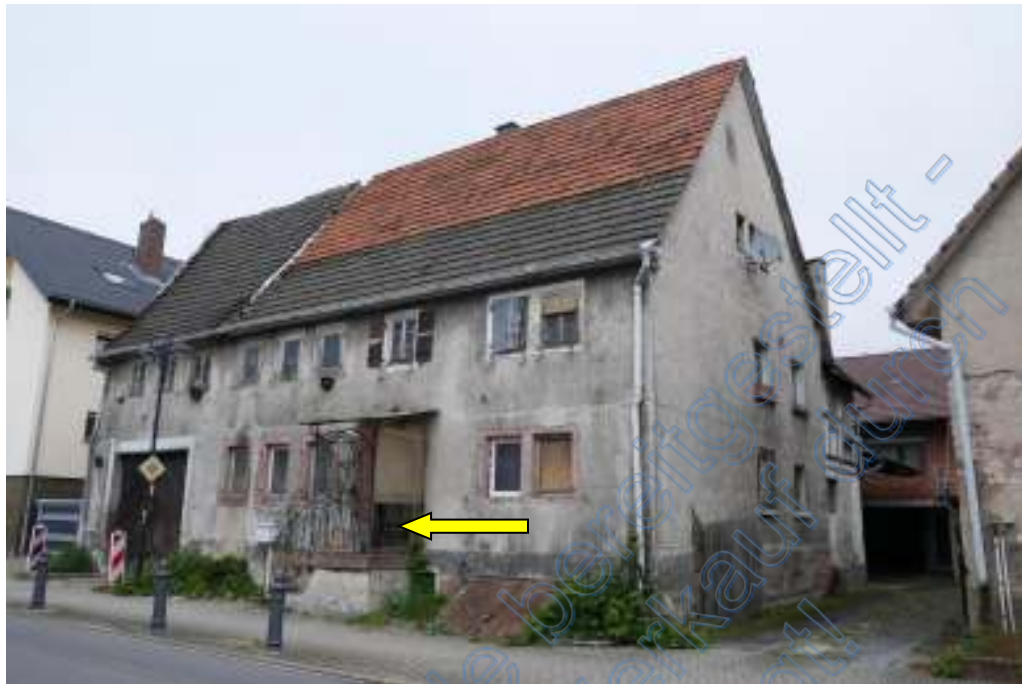
Straßenansicht von Süden auf das zu bewertende Wohnhaus. Am und im Gebäude sind umfangreiche Sanierungsmaßnahmen notwendig. Der gelbe Pfeil zeigt auf den Zugang zum Wohnhaus.
