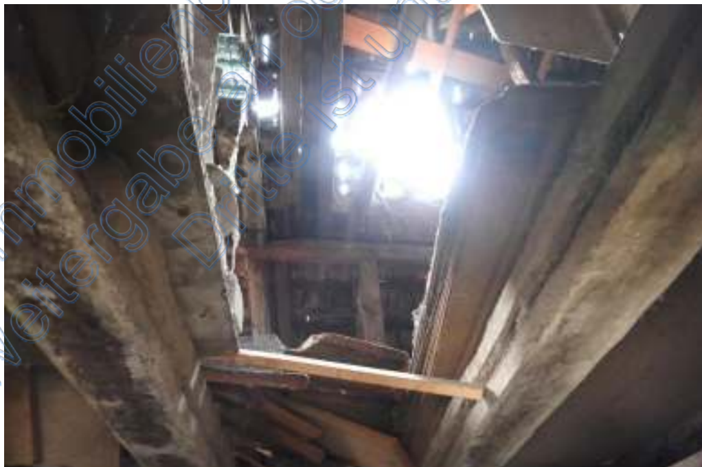
Es sind morsche Balken vorhanden und das Dach ist undicht.
