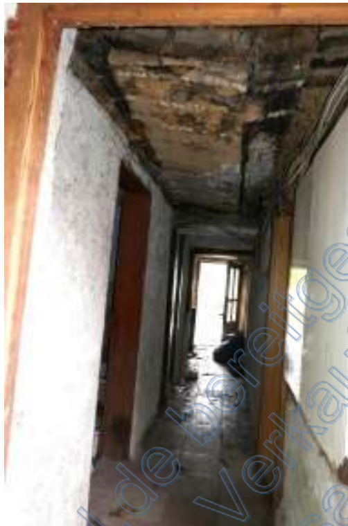
Blick in den hinteren Teil des Flures. Die Decke ist einsturzgefährdet.
