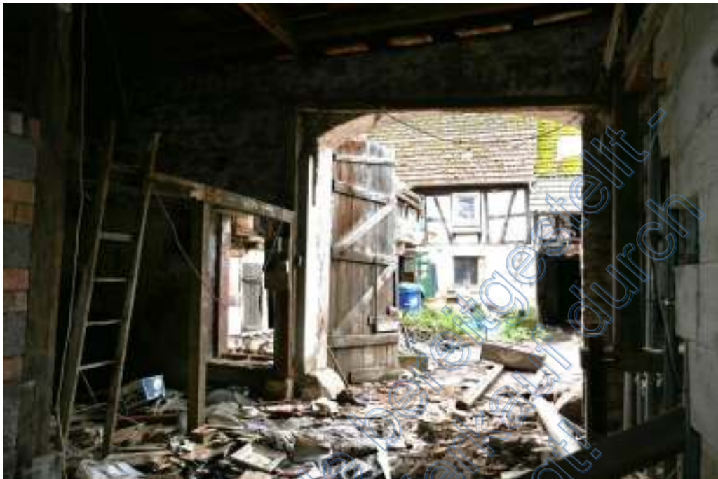
In der Scheune lagert diverser Unrat. Hier der Blick von der Scheune Richtung Innenhof.
