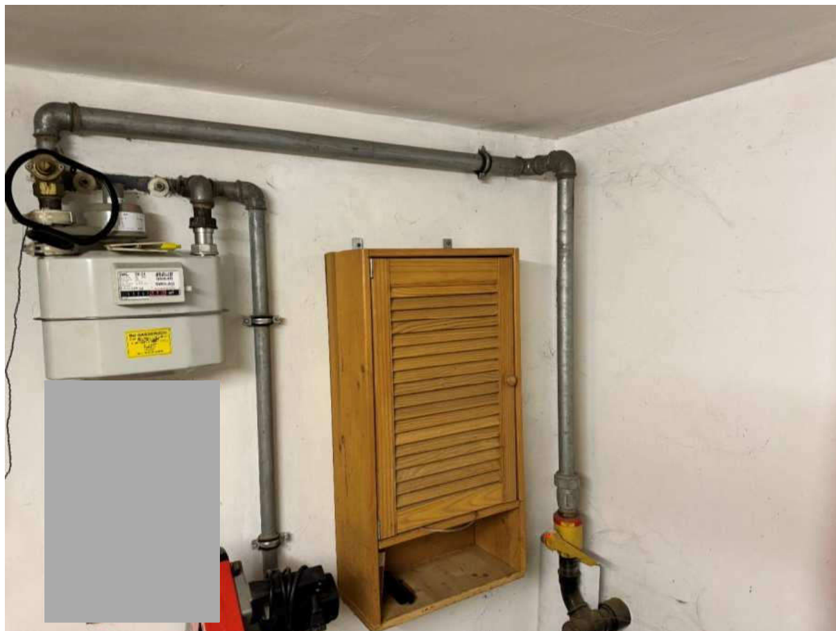
Abbildung 81 Gasanschluß (Teil des Bildes ist ausgeblendet)
