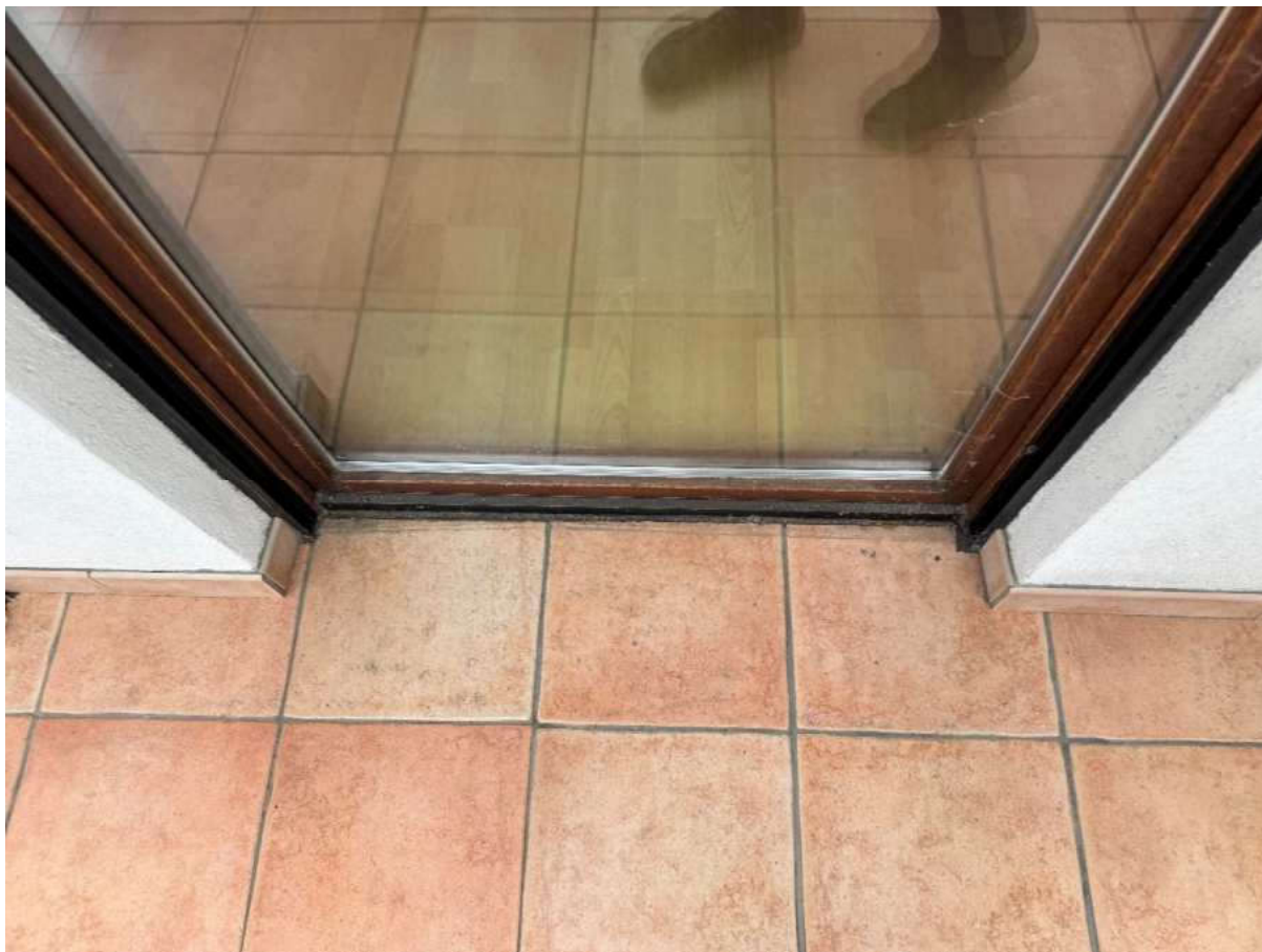
Abbildung 48 Detail Balkon - keine Entwässerung
