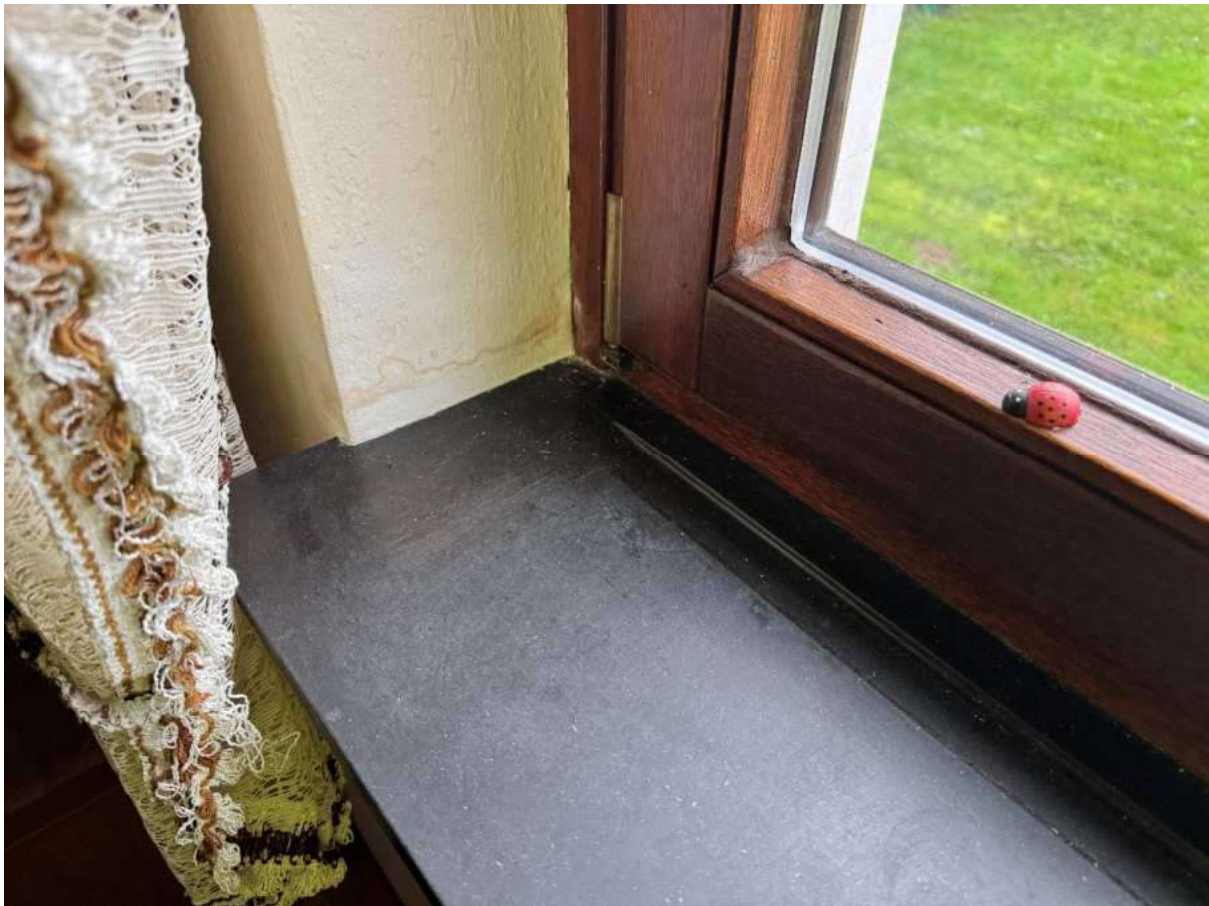
Abbildung 29 Detailansicht Fenster mit Leibung (Durchnässung)
