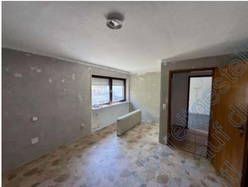
Bild 25: Nicht abgeschlossene Renovierung im 2. Obergeschoss (Wohnung links)
