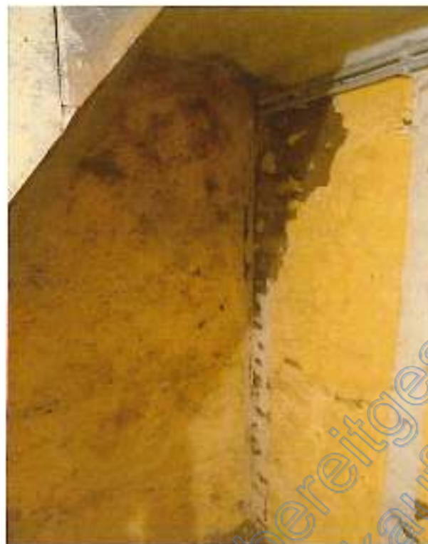
Foto 9: Feuchteschäden an der Kellerwand bei der Treppe
