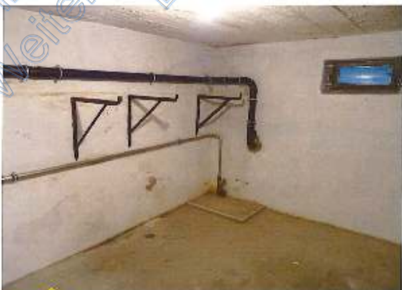
Foto 11: Kellerraum mit Feuchteschäden
