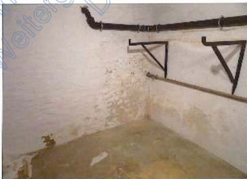
Foto 8: Feuchtigkeit der Kelleraußenwand und des Bodens
