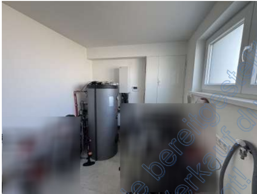
Bild 11: Hausanschlussraum im Erdgeschoss
