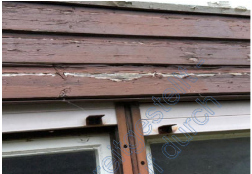
Abb. 3: Foto des SV; z.T. Holzverkleidung überaltert/schadhaft
