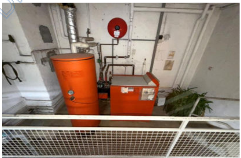
Abb. 14: Foto des SV; Heizungsanlage nicht zeitgemäß
