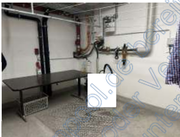
16 Blick auf die Hausanschlüsse für Wasser und Gas.
