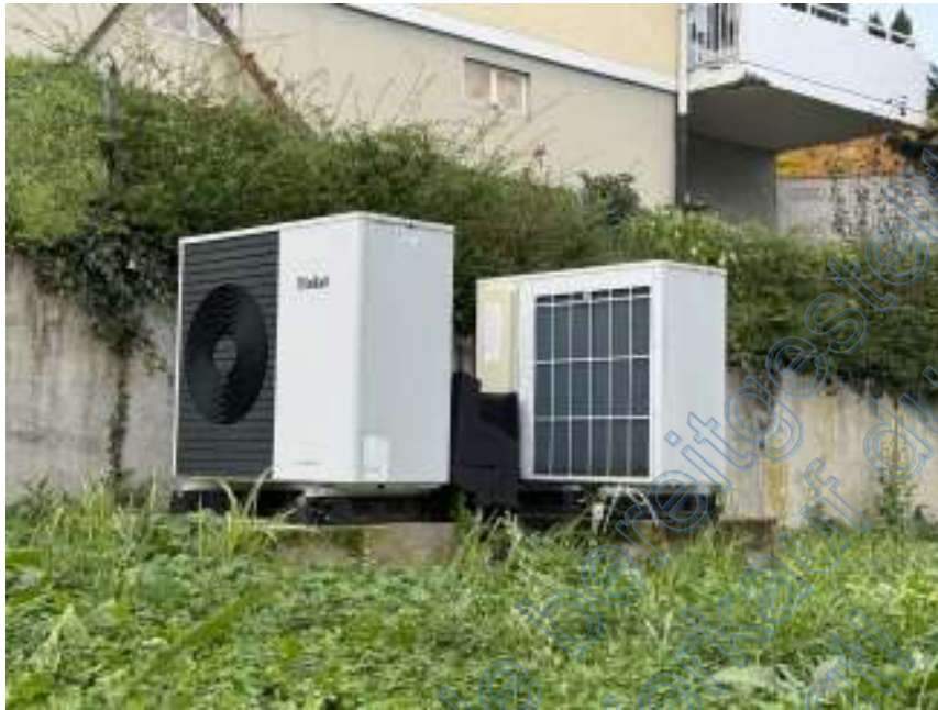
Bild 9: Wärmepumpe an der westlichen Grundstücksgrenze
