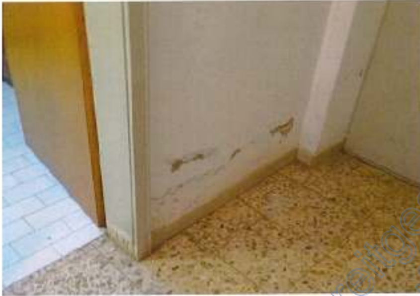
Foto 15: Reste eines Wasserschadens im KG
