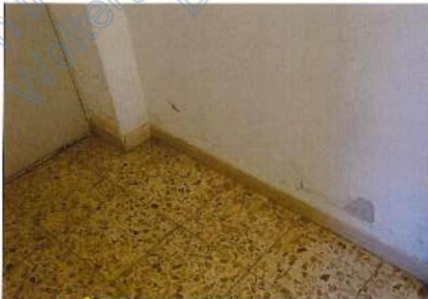
Foto 14: Reste eines Wasserschadens im KG
