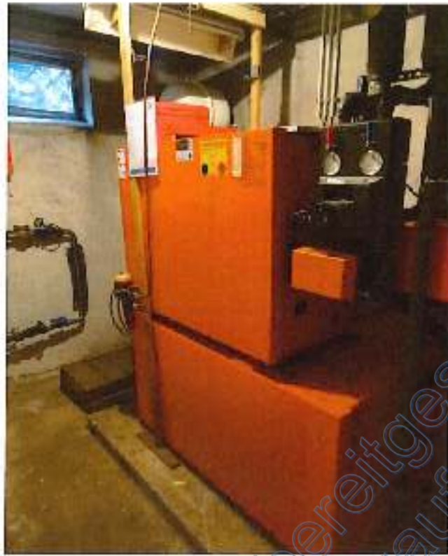
Foto 12: Heizungsanlage im Hausinstallationsraum, KG
