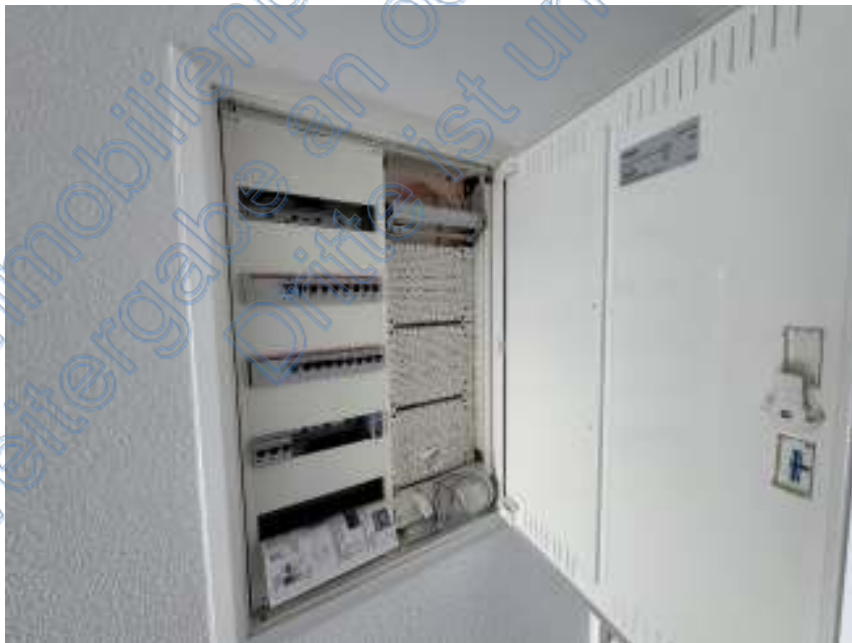
Bild 12: Elektrik/Sicherungskasten im Flur
