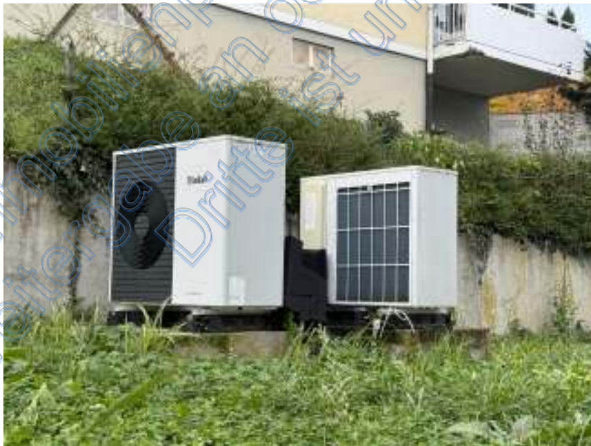
Bild 14: Wärmepumpe an der westlichen Grundstücksgrenze
