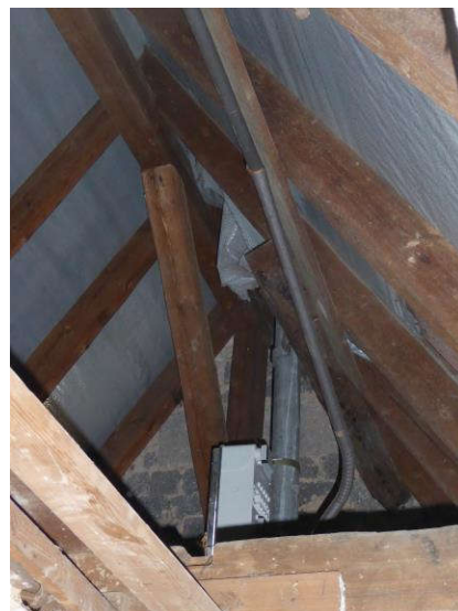
24. Spitzboden Hausanschluss Strom
