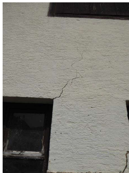
4. Rissbildung Außenwand Anbau
