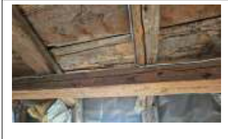
c) teilweise Holzwurmbefall Dachgebälk / Dechenbalken
