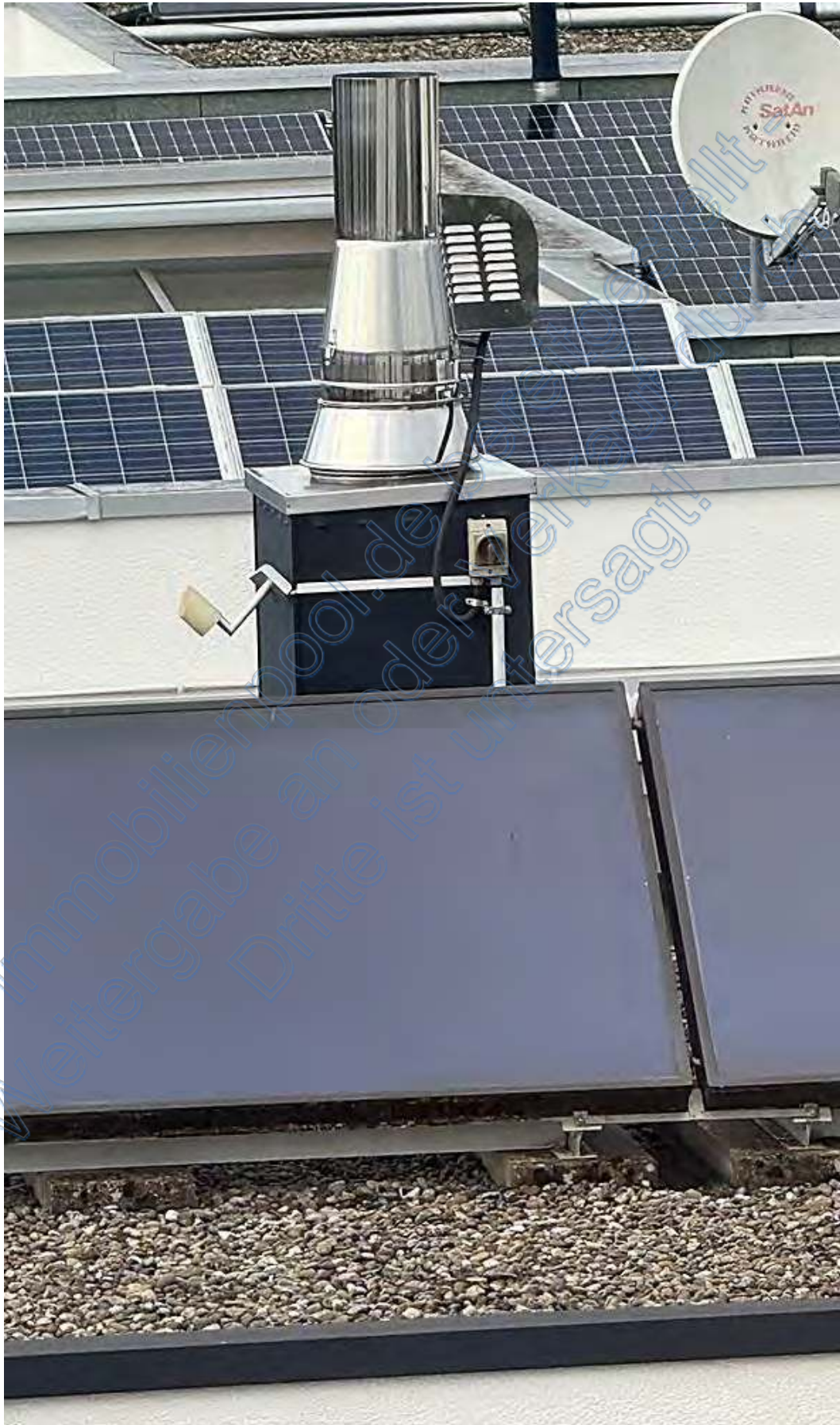
Schornstein vom Wohnzimmer, davor Solarplatten
