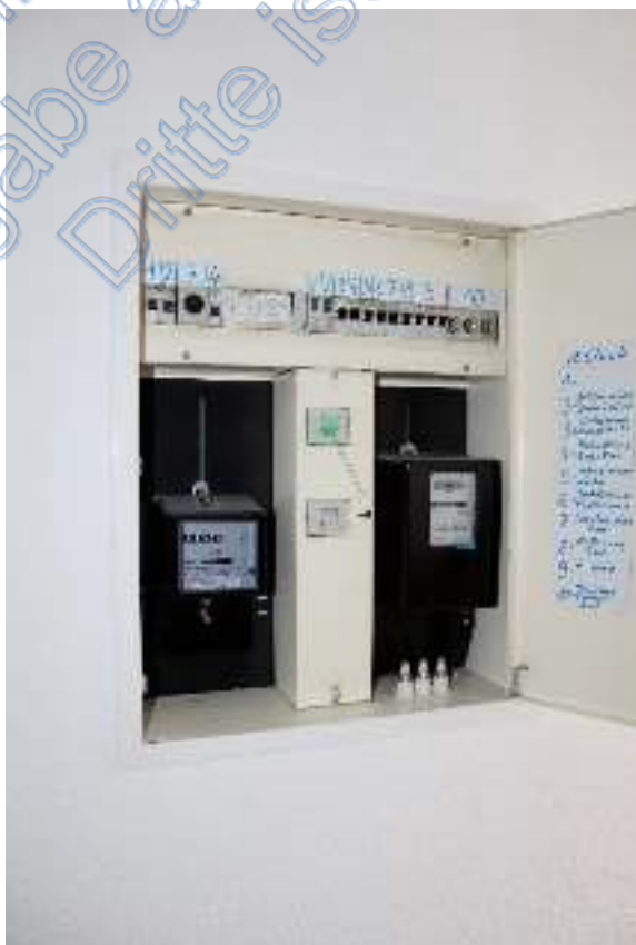
Foto 25: Stromzähler im Flur vor der OG-Wohnung
