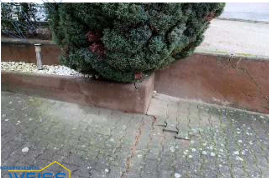
Foto 8: Einfahrt mit schadhaftem Pflasterbelag
