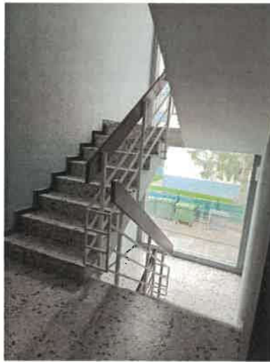
Linkes Foto: Treppenhaus im Bereich des 1. OG; rechtes Foto: Hauseingangstür zur Wohnung 17
