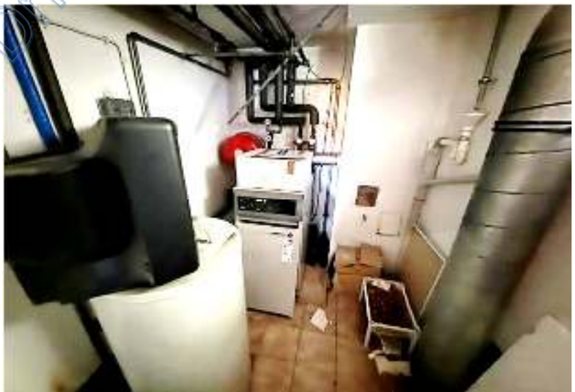
Foto 16 des SV: KG, Heizungsraum
