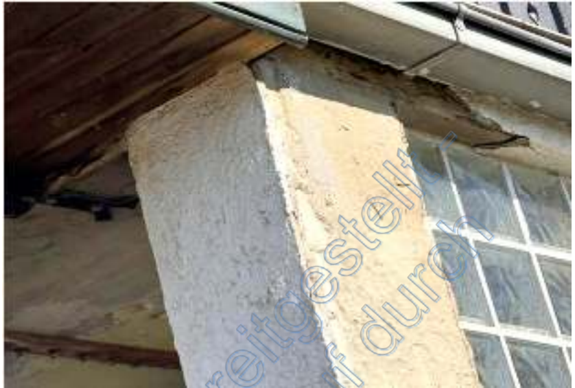
Abb. 3: Foto des SV; z.T. Fassade schadhaft (Putzabplatzungen)
