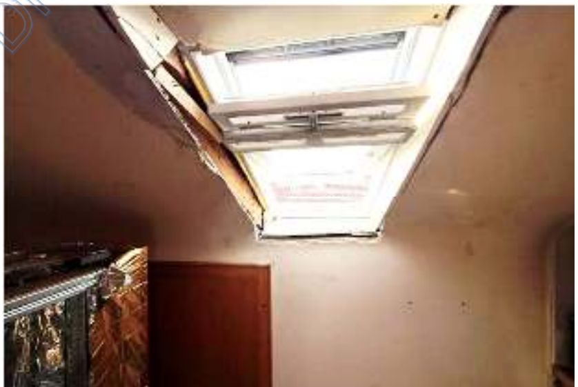
Abb. 5: Foto des SV; Dachfenstereinfassung schadhaft
