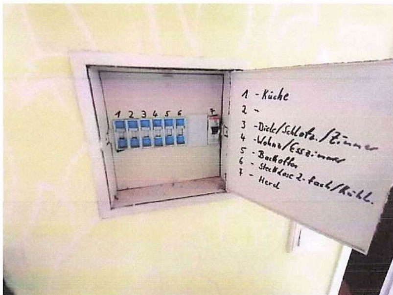
Aufnahme 10: Beispiel Elektrounterverteilung
