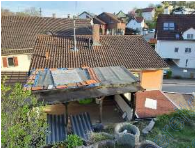
Instandhaltungsstau Überdachung Dachterrasse
