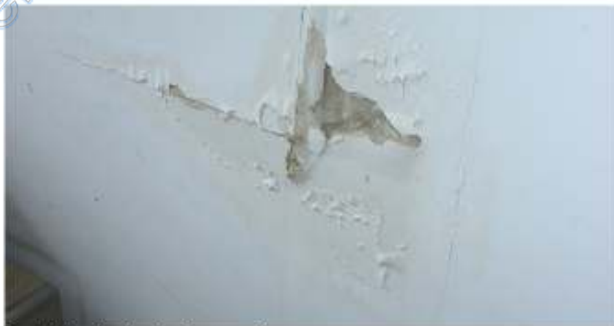
Anstrichschaden im Treppenhaus
