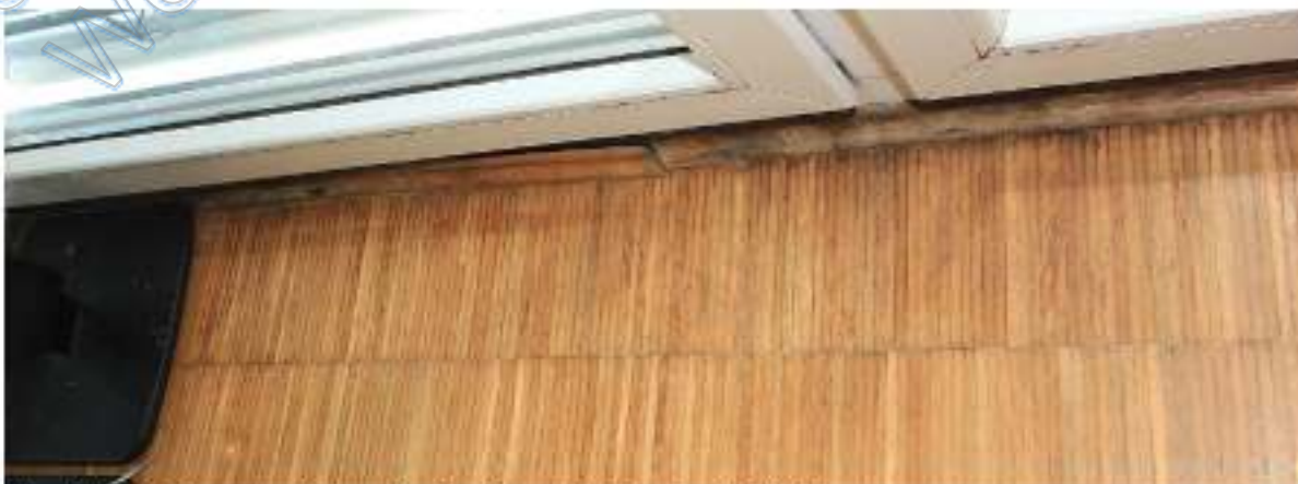
Feuchteschäden am Holzparkettboden und den Sockelleisten
