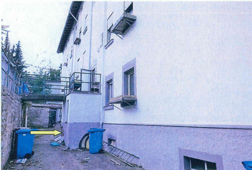
Blick auf den Bereich hinter dem Wohnhaus. Dieser macht ebenfalls einen ungepflegten Eindruck. An der rückwärtigen Fassade ist im Untergeschossbereich eine großflächige Putzabplatzung vorhanden (gelber Pfeil).
