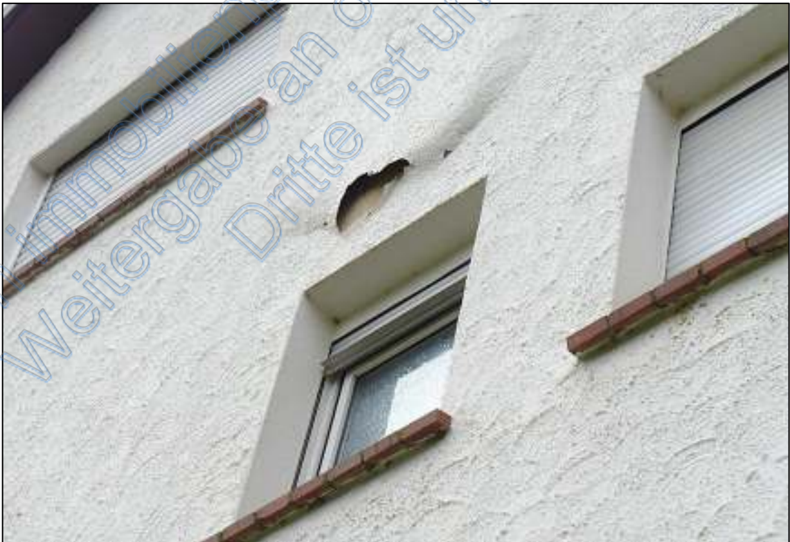
Bild 15 – Putzschaden an der Giebelwand
