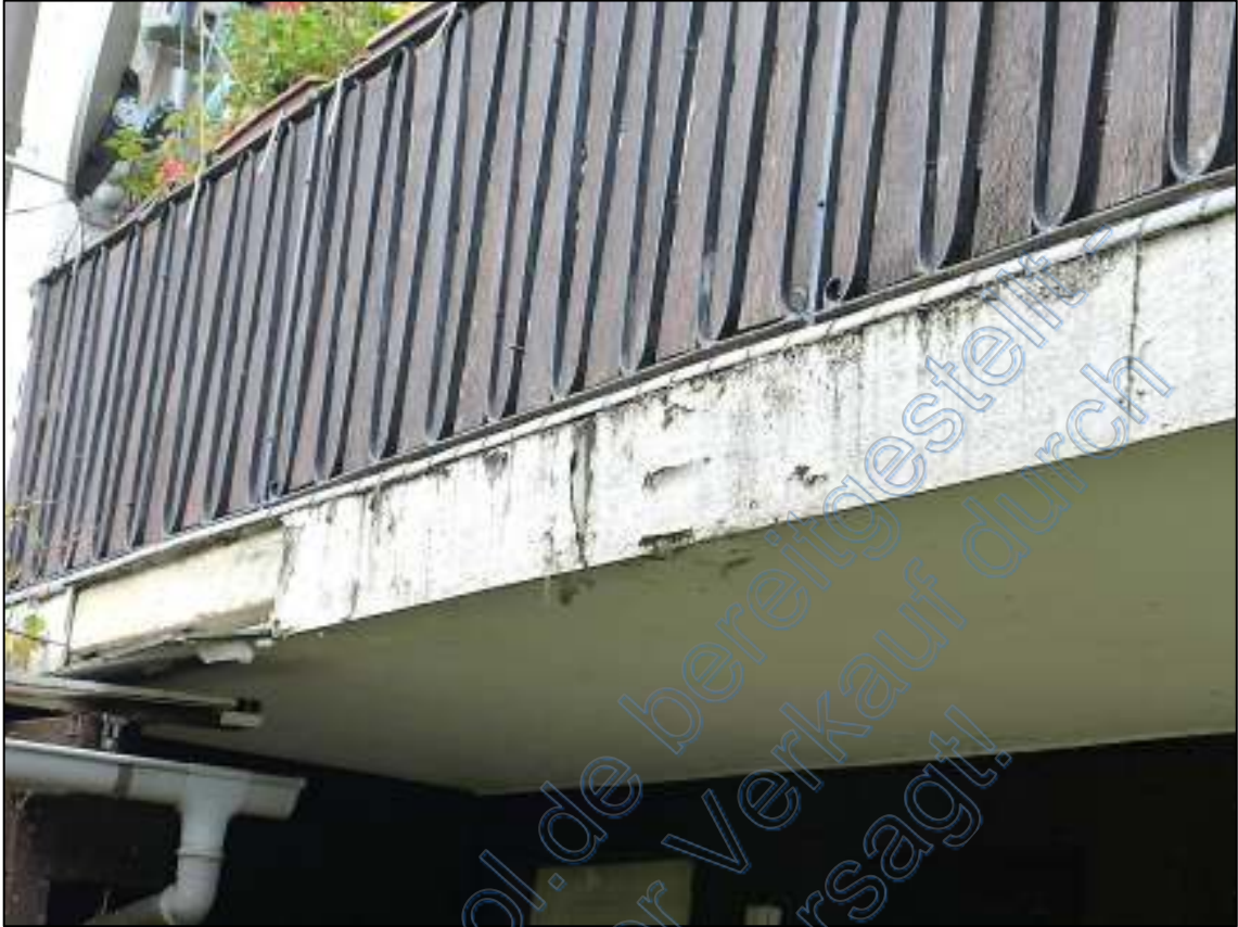
Bild 14 – Putzschäden am Balkon
