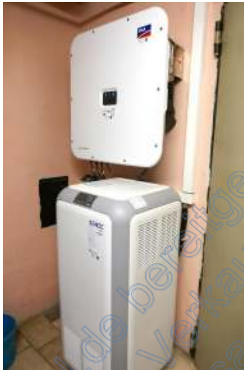
Im Untergeschoss befindet sich ein Photovoltaik-Heimspeicher.
